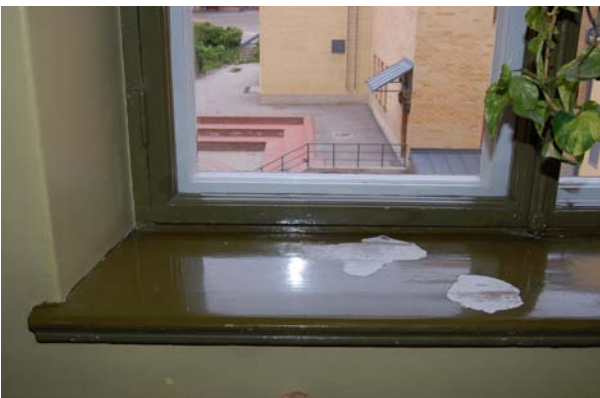
Puisen ikkunalaudan vaurioitunut pintakäsittely. Ikkuna sisäpihalle päin.
