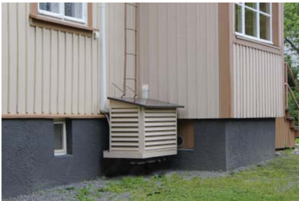
Ilmalämpöpumppu on koteloitu ja maalattu julkisivun väriseksi. Se on sijoitettu pois katujulkisivusta, lähelle maantasoa, kuistin "kainaloon".
