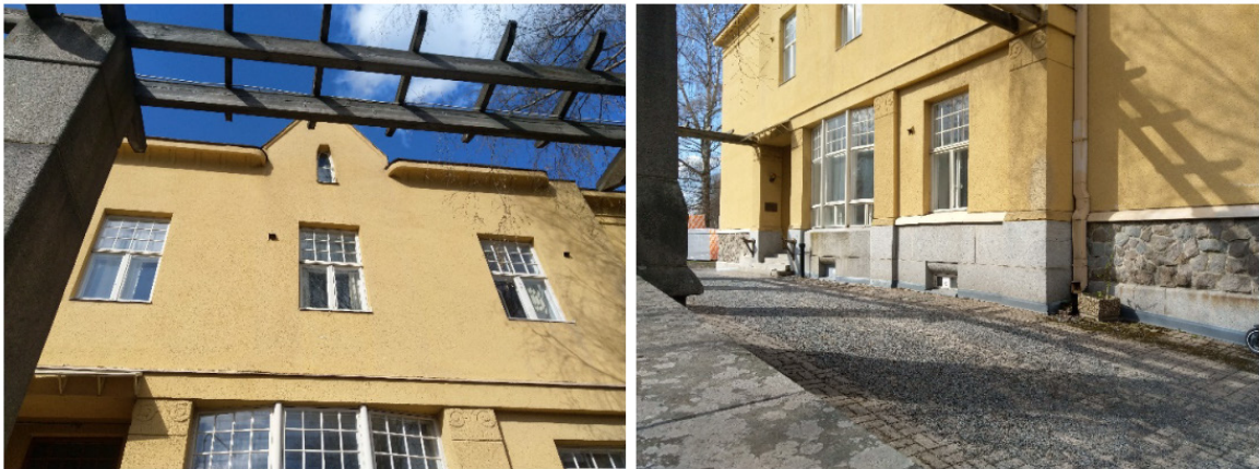
Kuva 10. De gamlas hem on kivirakenteinen. Perustuksissa tai kattorakenteessa ei havaittu rakoja lukuun ottamatta takaseinustan vesikaton ja seinän väliä, jossa saattaa olla vapaita rakoja lepakoille.
