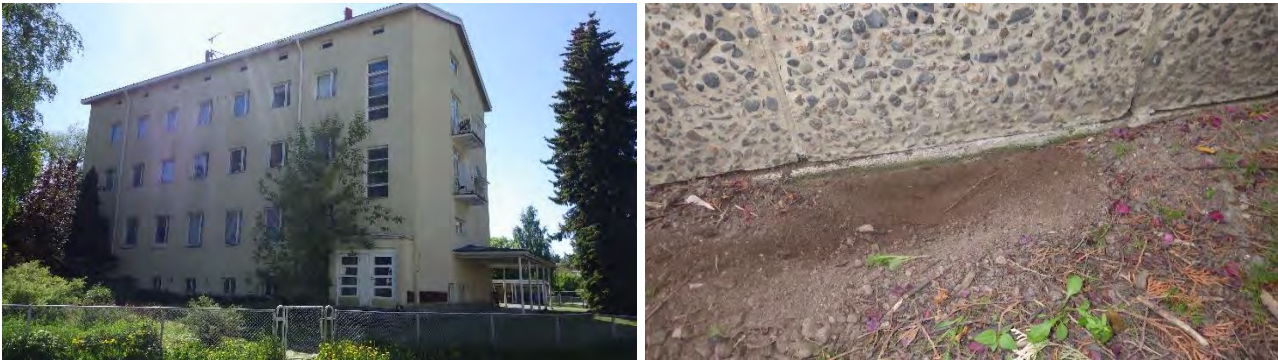
Kuvat 4a ja b. a) Idän puoleisella julkisivulla on nurmea ja istutuksia. b) Rakennuksen maanvastaisissa seinissä ei ole havaittavissa ulkopuolista kosteudeneristystä tai perusmuurilevyä lastentalon eteläpuolista sivua lukuun ottamatta.
