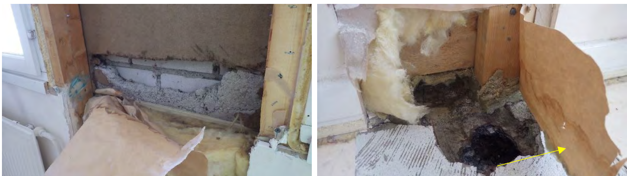
Kuvat 27 a ja b. a) Rakenneavaus RA-US5a. Vanha betoninen parvekekaide on jätetty seinärakenteen sisälle. Seinärakenteen mineraalivillassa ja puukuitulevyssä on laboratorioanalyysin perusteella mikrobikasvustoa. Sisäpinnan paperissa on kuivuneita kosteusjälkiä. b) Rakenneavaus RA-US5b. Sisäverhouksen takana olevassa paperissa kosteusjälkiä seinän ja välipohjan liittymäkohdassa.
