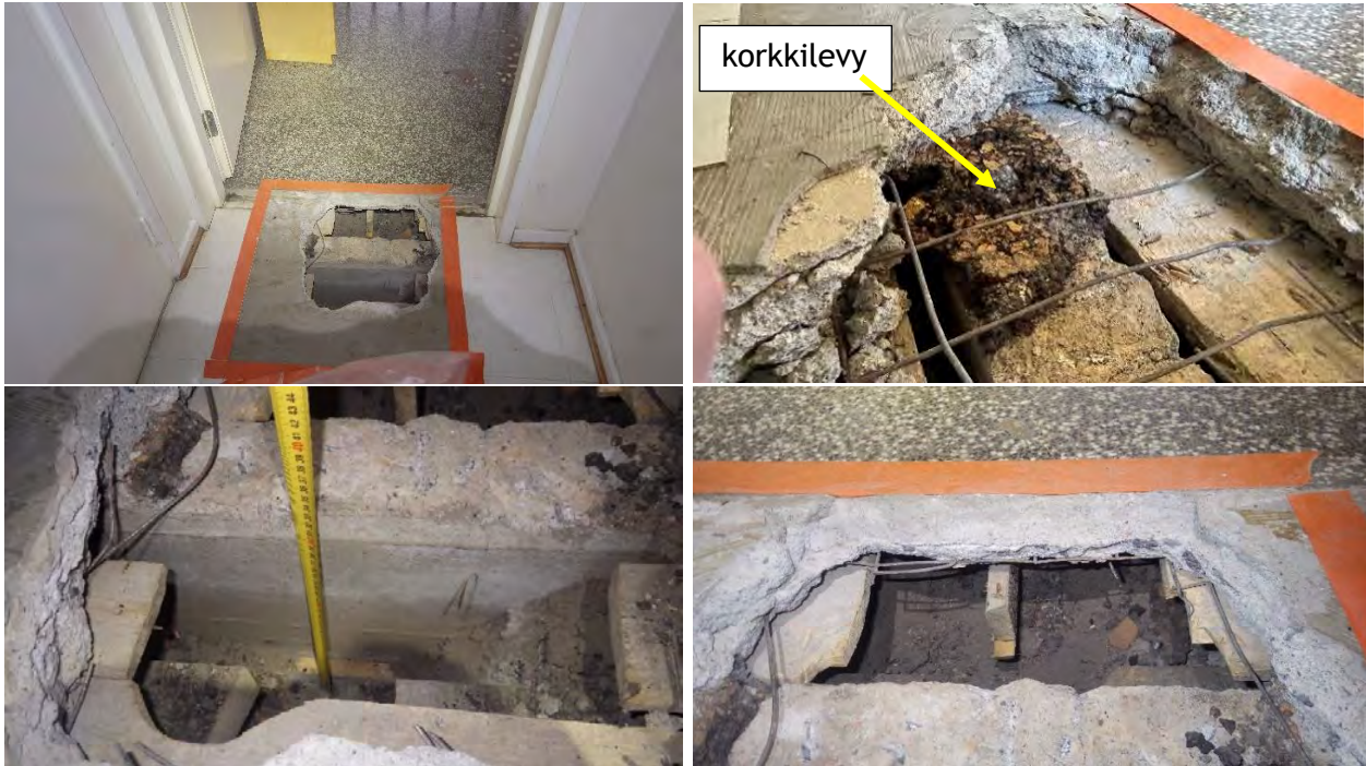
Kuvat 31 a-d. Rakenneavaus RA-VP5 alalaattapalkistoon. Rappukäytävän osuus on mosaiikkipinnalla (jonka pintarakennetta ei tutkimuksessa rikottu/ avattu) ja avaus tehtiin tämän takia mosaiikkilaattaosuuden rajakohtaan. b) Palkin päällä korkkieriste noin 30 mm. c) Palkiston reunoilla ja pintalaatan alla muottilautoja. d) Erilliset puukannattimet pintalaatan muottilauoitukselle.
