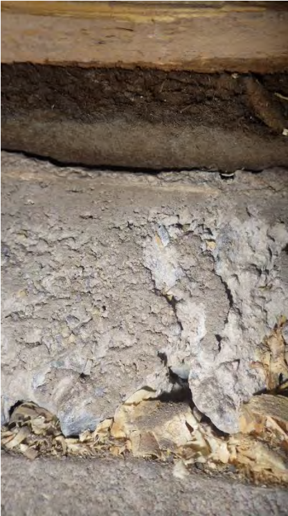
Kuva 41. a) Rakenneavaus RA-YP5 tehtiin yläpohjan palkkilinjan viereen. Palkin on erillinen puukuitulevykaista. Puukuitulevy haisi vahvasti kreosootille ja PAH(16) -summapitoisuudeksi määritettiin laboratoriossa 25000 mg/kg.
