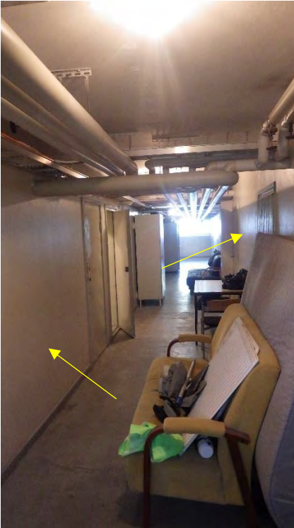
Kuva 16. Kuva asuntosiiven kellarin käytävältä. Kantavissa väliseinälinjojen alaosissa ei havaittu kohonneita pintakosteusilmaisimen arvoja.
