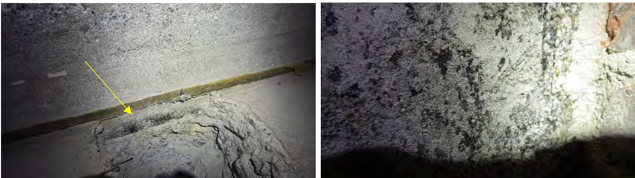
Kuvat 15 a ja b. a) Alapohjan ja kantavan väliseinän liittymässä on pikisively. b) Pikisivelyä on osin nostettu myös lattiatason yläpuolelle. Havainnot tilasta 016. Seinälinjasta ei havaittu kohonneita pintakosteusilmaisimen arvoja.
