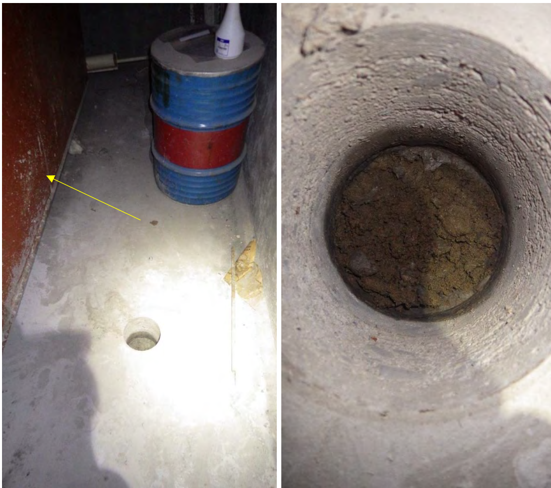
Kuvat 22 a ja b. a) Öljysäiliön (keltainen nuoli) viereen tehty rakenneavaus RA-AP3 tilassa 023. Kulku tilaan oli seinässä olevan luukun kautta. b) Alalaatan kokonaispaksuus on noin 150 mm, jonka välissä pikikerros ja alla hiekkakerros. Avauskohdan pintalaatasta ja maaineksesta otettiin myös öljyhiilivetynäytteet.
