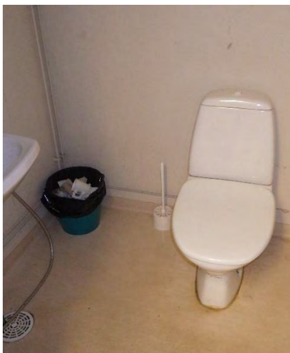
Kuva 45. Yleiskuva asuntosiiven kellarikerroksen pukuhuoneen wc-tila (tila 034). Lattiassa todettiin paikoin jonkin verran poikkeavia pintakosteusilmaisimen lukemia.
