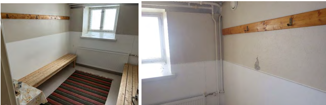
Kuvat 44 a ja b. Asuntosiiven kellarikerroksen pukuhuone (Tila 033). Lattia- ja seinäpinnoissa todettiin normaalista poikkeavia pintakosteusilmaisimen lukemia. Mm. seinien alaosien pintoja on korjattu jo aiemmin kosteusongelmien takia.
