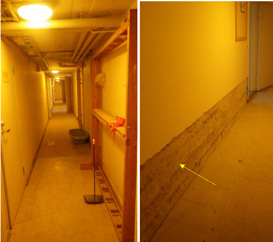
Kuvat 14 a ja b. a) Lastentalon kellarin kantava väliseinälinja käytävän kohdalla. b) Kantavan seinälinjan maali-/ rappaus on poistettu aiemmin kellarikerroksessa olevien kosteusongelmien takia. Tutkimusten aikana seinälinjasta ei havaittu näissä kohdissa kohonneita pintakosteusilmaisimen arvoja. Pinnoitteet on poistettu seinien alaosista jo useampia vuosia sitten.
