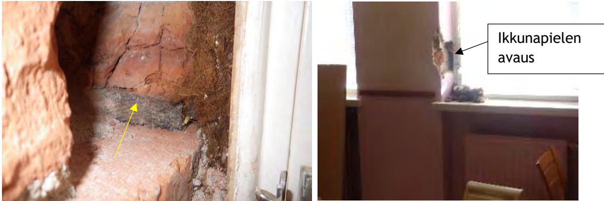
Kuvat 26 a ja b. a) Rakenneavaus RA-US2 ulkoseinän ja ikkunan liittymäkohtaan. Ikkuna on naulattu tervattuun puutiileen, jossa todettiin vahva kreosootin haju. Ikkunan tilkkeenä on käytetty mm. pellavarivettä, jossa todettiin myös vahva kreosootin haju. b) Yleiskuva ikkunaliittymistä ja patterisvyennyksistä.
