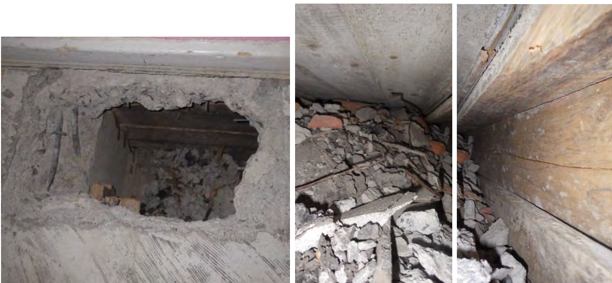
Kuvat 30 a-c. a) Rakenneavaus RA-VP2 palkin ja ulkoseinän liittymäkohdassa. b) Täyttökerroksen paksuus vaihtelee paikoittain. Täytön seassa tiilen kappaleita ja laastipursetta. c) Muottilaudat kiinni palkin kyljessä.
