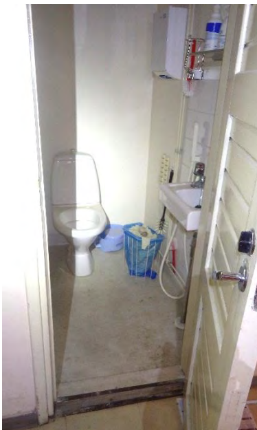
Kuva 54. Yleiskuva (tila 003) wc-tilasta. Lattiassa koholla olevia pintakosteusilmaisimen lukemia.
