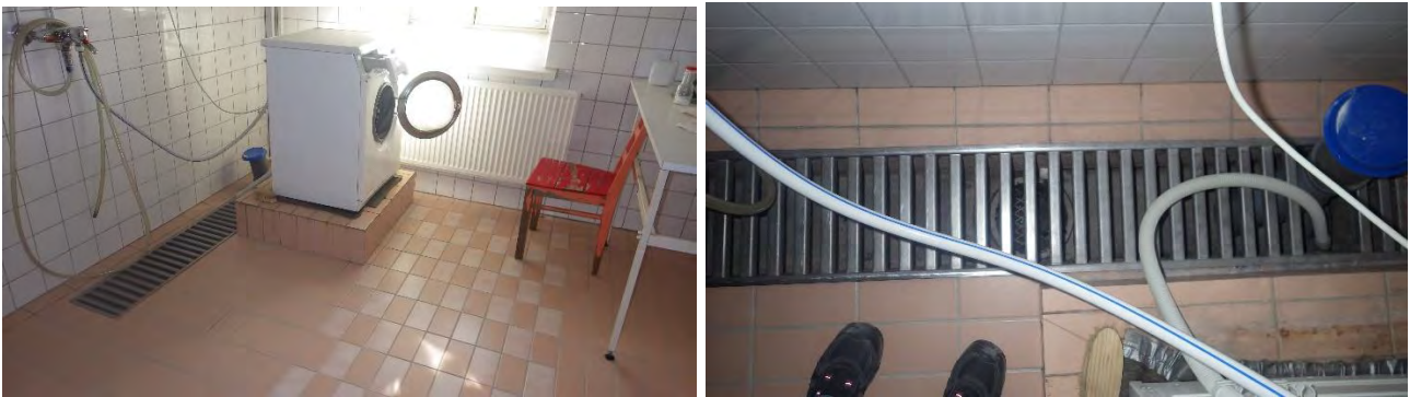
Kuvat 43 a ja b. Asuntosiiven kellarikerroksen pesutupa (Tila 028). Pinnoissa todettiin koholla olevia pintakosteusilmaisimen lukemia.
