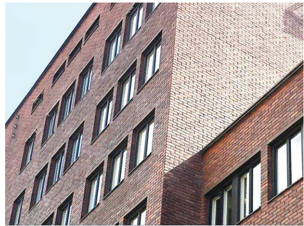
Kuva 17. Matalamman osan ja korkeamman osan julkisivujen ikkunapalkkien maalipinnoitteet sisältävät lyijyä yli vaarallisen jätteen raja-arvon, näytteet 44 (matala osa) ja 45 (korkea osa).
