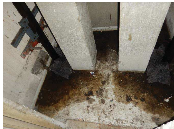
Kuva 20. Mineraaliöljyjäämiä alapohjalaatan pinnalla, hissikonehuone, porrashuone 012, alakellari.
