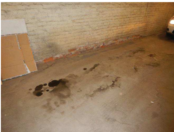
Kuva 19. Mineraaliöljyjäämiä alapohjalaatan pinnalla, autotalli (suutari) 011, yläkellari / 1. kerros.
