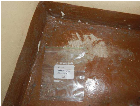
Kuva 16. Lyijyä yli vaarallisen jätteen raja-arvon sisältävä lattiamaaali, porrashuone 005, alakellari, näyte 11.
