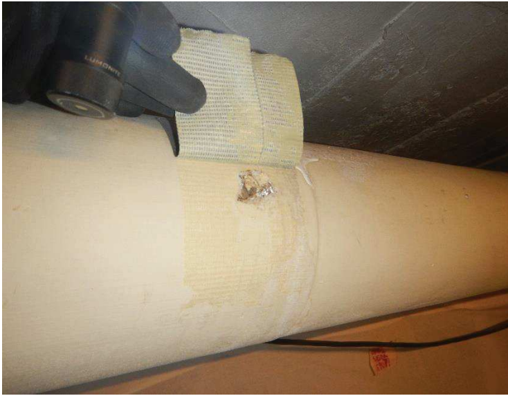
Kuva 1. Asbestipitoinen putkieriste, harjoitus- ja varastotila (bänditila, ent. autotalli) 007, alakellari.
