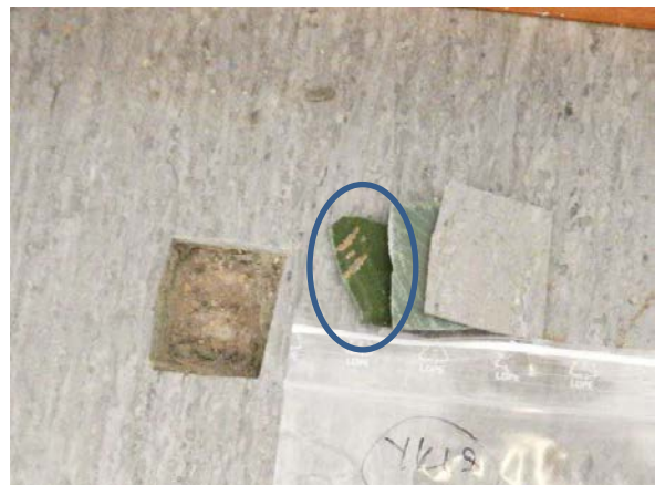
Kuva 5. Asbestipitoinen vinyylilaatta (250 x 250 mm 2 ) uudempien lattiapäällysteiden alla, opetustila (autismisäätio), 7. kerros, näyte 19.
