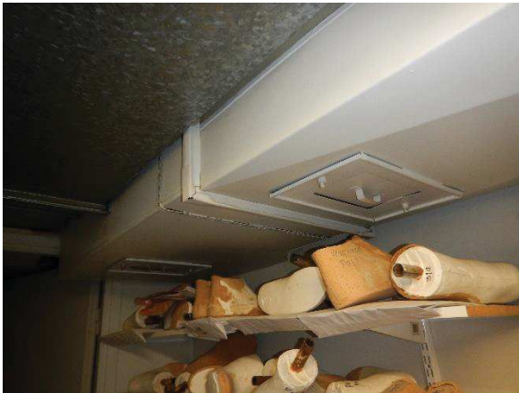
Kuva 11. Vanhojen ilmanvaihtokanavien limitysten ja liitosten mahdolliset tiivistesarut ja tiivistysmassat voivat sisältää asbestia. Kuva yläkellarin / 1. kerroksen käytävältä 109 (suutari).
