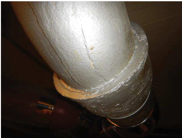
Kuva 14. Valurautaviemäreiden muhviitoksissa on lyijytiivisteet, joten lyijytiivisteitä sisältävät valurautaviemärien osat ovat lyijyn suhteen vaarallista jätettä. Kuva alakellarin autotallista 002.
