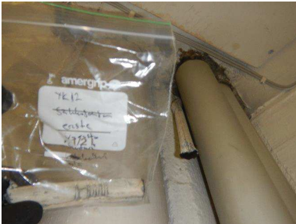
Kuva 13. PAH-yhdisteitä yli vaarallisen jätteen raja-arvon sisältävä sisältävä sähköjohtoeriste, työtila (suutari, ent. ilmanvaihtokonehuone/varastotila) 110, yläkellari / 1. kerros, näyte 12.
