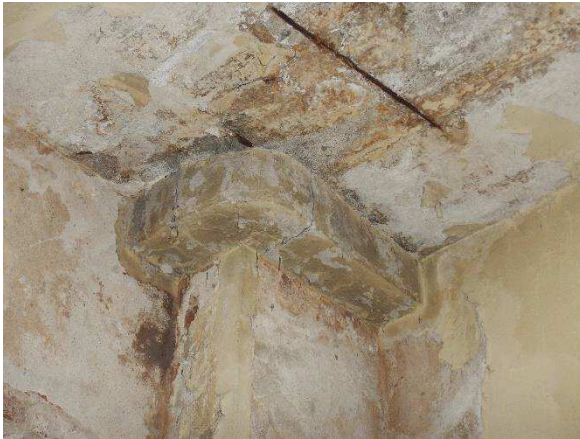
Kuva 6. Asbestipitoinen kuitusementtirakenteinen ilmanvaihtokanava, varastotila 006 alakellari.
