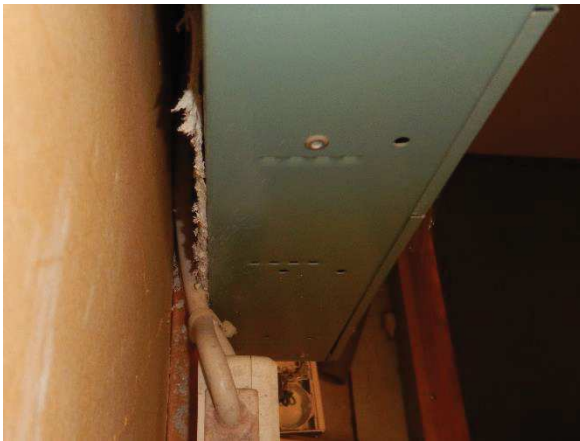
Kuva 8. Asbestipitoinen eristelevy sähkökeskuksen taustalla, sähkökeskus, 6. kerros.
