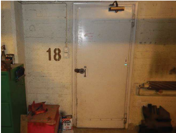
Kuva 9. Vanhat palo-ovet ja niiden karmit sisältävät todennäköisesti asbestia. Kuva alakellarin autotallista 002.
