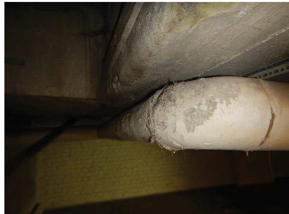
Kuva 3. Paikoin asbestipitoiset putkieristeet ovat rikkoutuneita ja huonokuntoisia. Kuva yläkellarin / 1. kerroksen varastotilasta.
