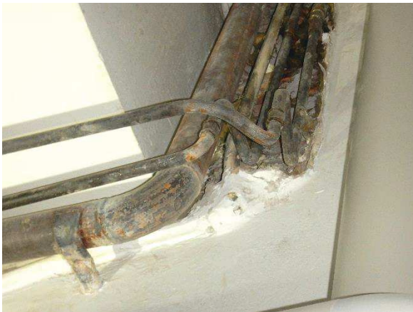
Kuva 2. Asbestipitoisia putkieristeitä on poistettu, mutta niiden jäämiä on jäänyt putkien ja rakenteiden pinnoille. Kuva porrashuoneesta 005 alakellarista.
