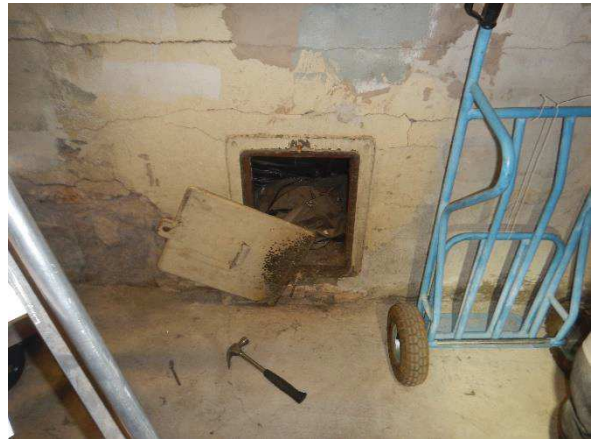
Kuva 12. Mahdollisesti asbestipitoisia materiaaleja sisältävä savusola, lämmönjakuhuone 008, alakellari.
