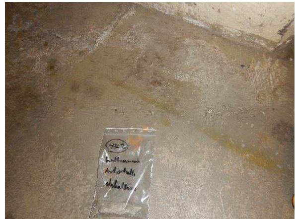
Kuva 15. Lyijyä yli vaarallisen jätteen raja-arvon sisältävä lattiamaaali, autotalli 002, alakellari, näyte 2.
