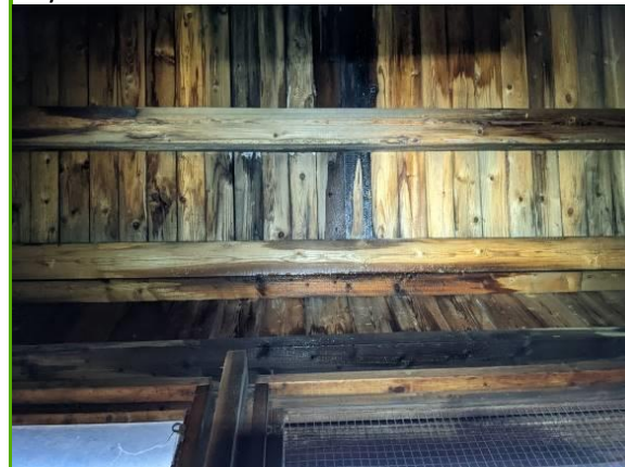
B-halli: vesivuotojälkiä sisäpinnoilla, vuodot kas- televat ulkoseinää
