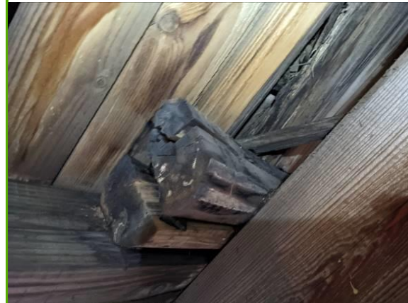
C-halli: orsia ja ruodelautoja lahonnut vesivuodoista
