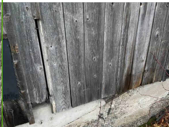
B-varasto, etelä: useita rimoja puuttuu, lautoja rikkoutunut
