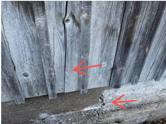
B-talo: sokkelin halkeama jatkuu julkisivuun rikkoen laudan
