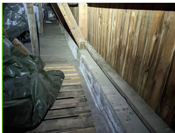
Sokkelissa voimakasta kalkkihärmää
