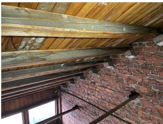
C-halli: orsien halkeilua, betonikonsolit muurauksessa
