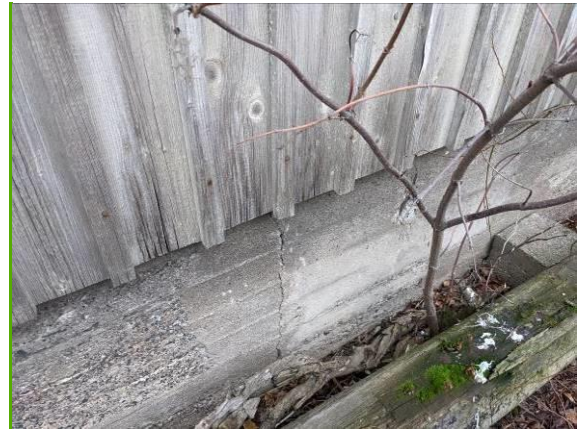
Halkeama kehän kohdalla, betonin pinta eh- jempi
