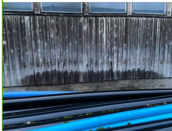
B-varasto, itä: kattovedet kastelevat julkisivujen alaosa
