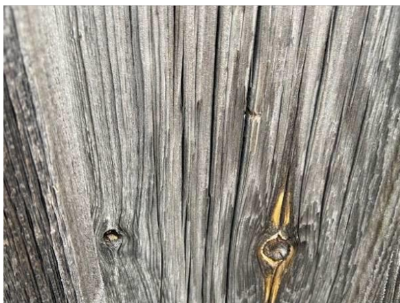
B-varasto, eteläpääty: julkisivulaudoituksen halkeilu voimakasta
