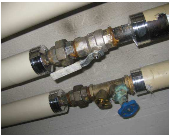
Lämmitysverkoston linjaventtiilit alkavat olla ikääntyneitä
