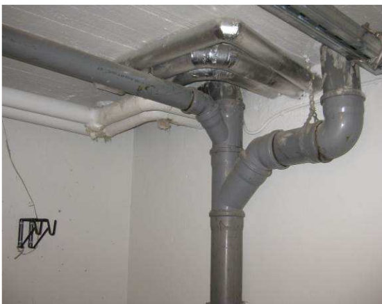
Viemärit ovat pääosin muoviviemäreitä
