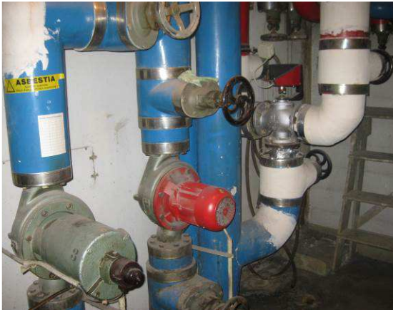
Lämmitysverkoston pääpumppu on vuodelta 1991
