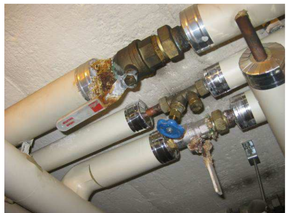
Osa linjaventtiileitä ei enää sulkeudu, tai sulkeumisyritys aiheuttaa vuodon
