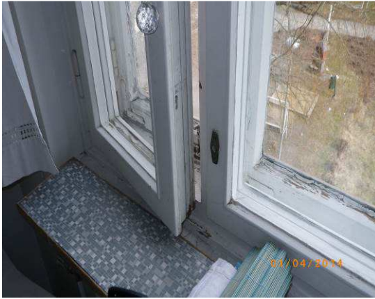
Ikkunoiden kunto on välttävä.
