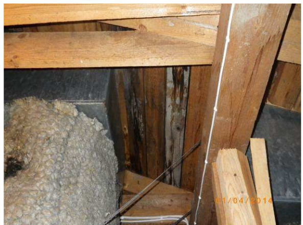
Vesivuotojälkiä vesikaton rakenteissa.
