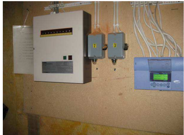
Uusittua ilmanvaihtokoneen säätölaitteistoa
