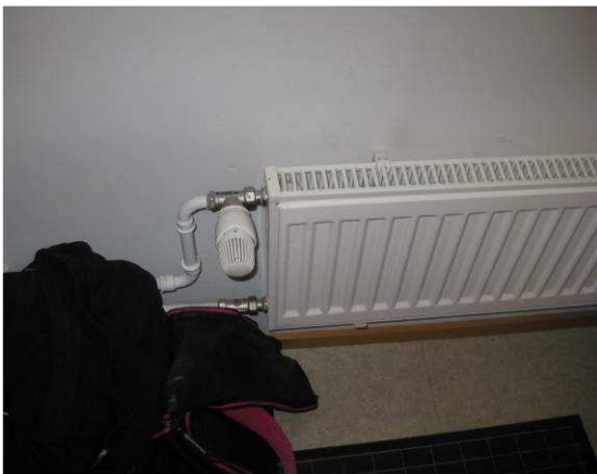
Patteriventtiili 2000-luvulta, uusittu patteri
