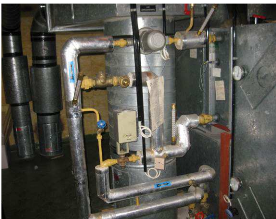
Ilmanvaihtokoneiden kentälaitteet ovat pääosin 1980-luvulta
