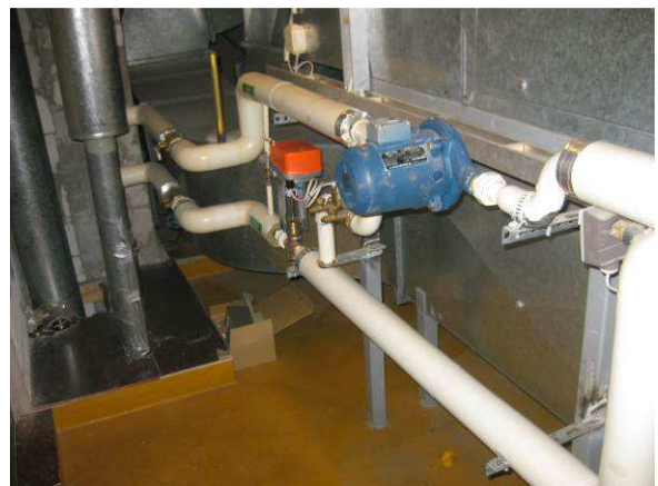
Ilmanvaihtokoneiden kentälaitteita on uusittu yksittäin tarpeen mukaan
