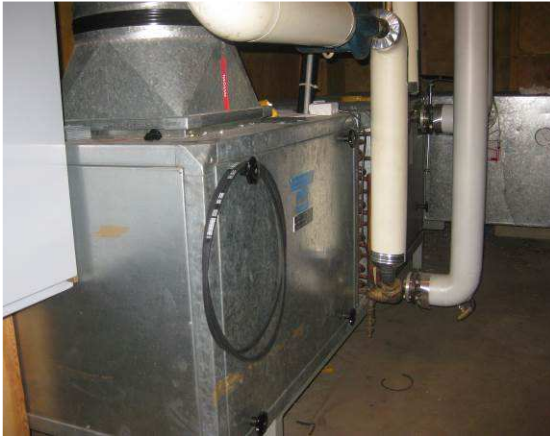
A-talon toista tuloilmakonetta on saneerattu noin 1990-luvun puolivälissä
