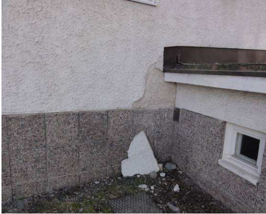
Paikallinen vaurio julkisivun rappauspinnoitteessa.
