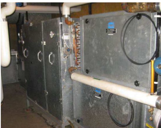
Ilmanvaihtokoneet ovat perusrungoiltaan noin 1980-luvun puolivälistä
