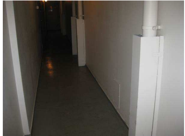
Pystyviemäreitä (muovia, D-talon kellari)
