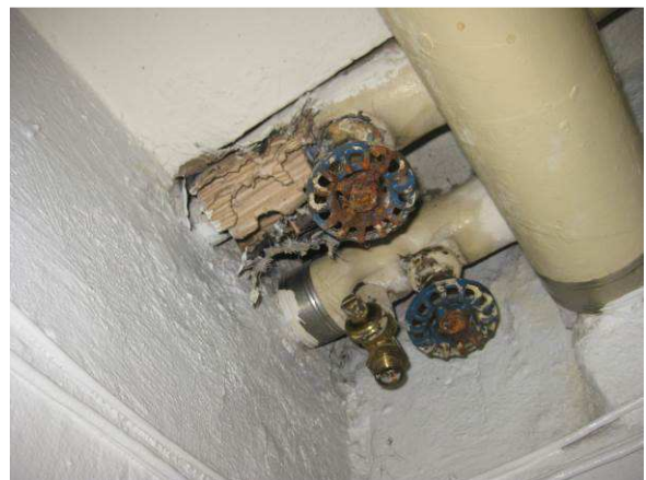
Osa linjaventtiileitä on alkuperäisasennuksia 1960-luvulta
