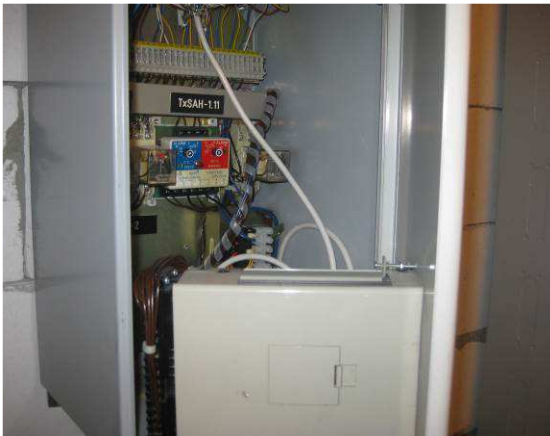
Osa ilmanvaihtokoneiden säätölaitteista on 1980-luvulta
