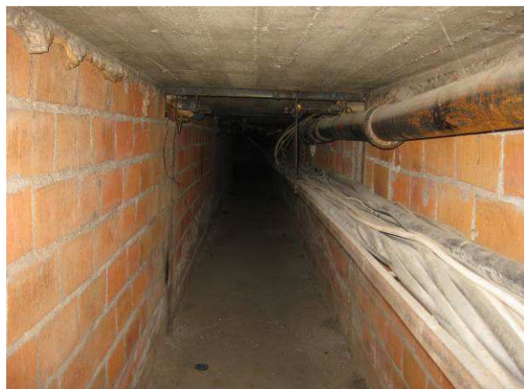
Vanhaa valurautaviemärointiä talon B/C alla olevassa kanaalissa
