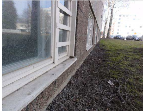
Ikkunoiden vesipellityksissä on jonkin verran puutteita.
