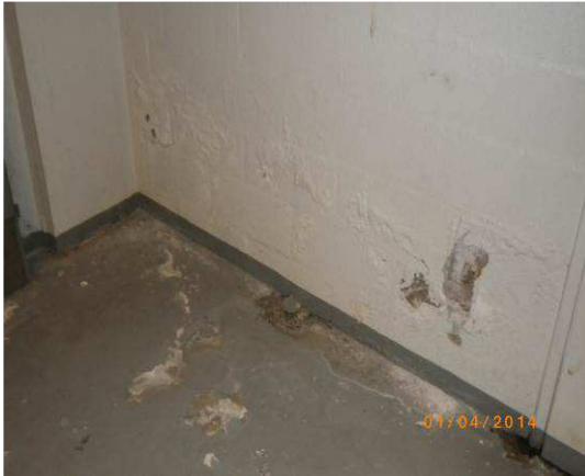
Kosteuden aiheuttamia jälkiä alapohjarakenteessa ja seinässä.
