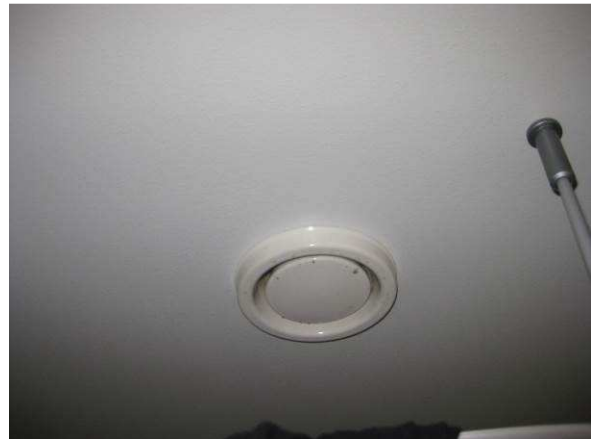
Poistoilmaventtiilit ovat pääosin tavanomaisia kartioventtiileitä
