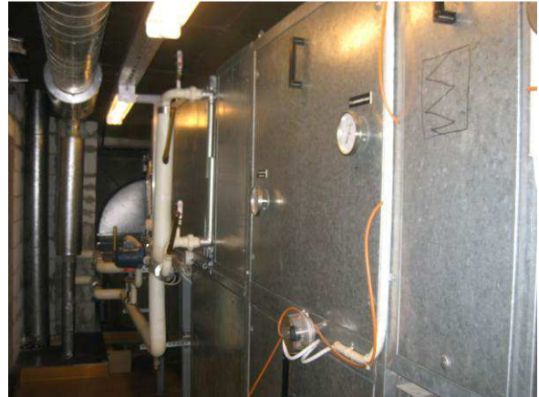
Pääilmavaihtokoneet ovat kokonaisuutena tyydyttävässä kunnossa
