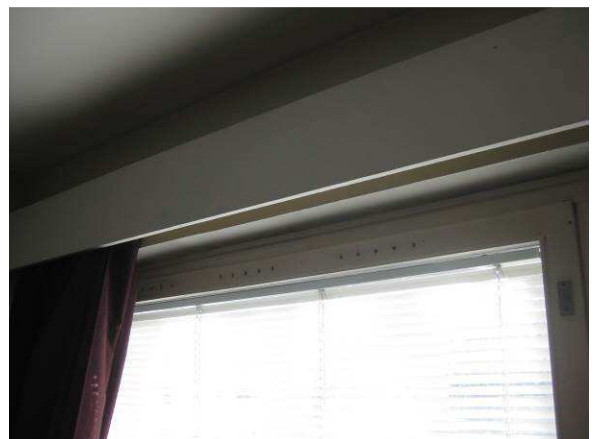
B-osan asuntojen ikkunapuitteisiin on porattu korvausilma-aukkoja
