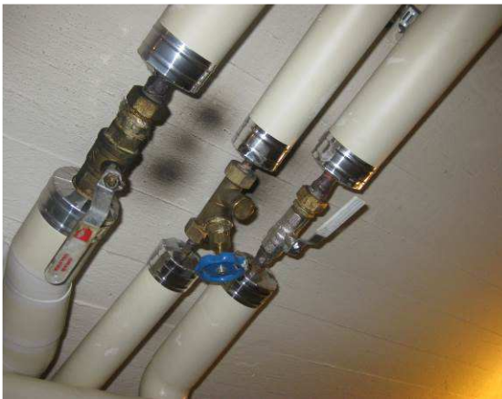
Vesijohtojen linjaventtiilit ovat keskimäärin välttävässä kunnossa
