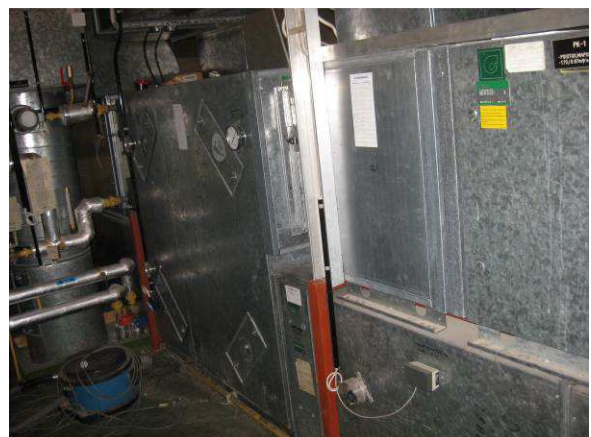
Ilmanvaihtokoneissa on LTO-järjestelmät
