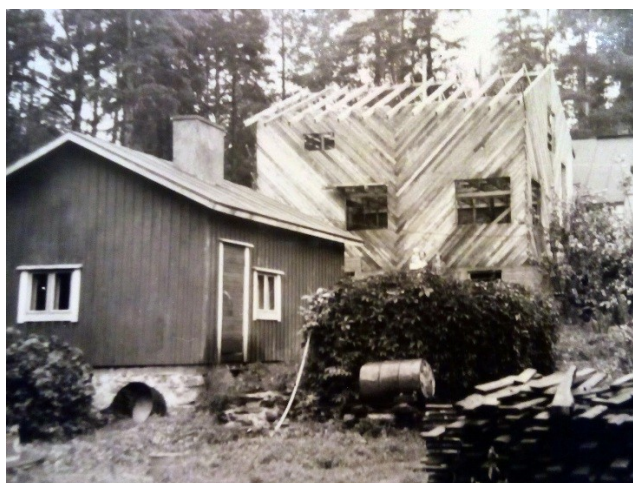
Kuva 6. Uuden päärakennuksen ensimmäisen osan rakentuessa vanha saunarakennus on ollut vielä paikallaan. Kuvat saatu hakijalta.
