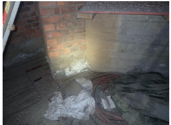
Kuva 3 Sokkeleiden alaosissa esiintyy kosteusvauriojälkiä.
