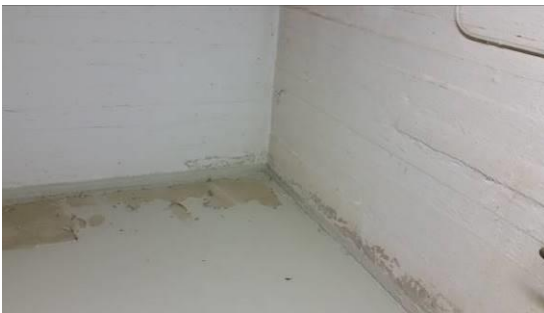
Maalipinta hilseilyt väestönsuojan reuna-alueilta
