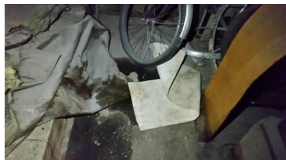
Öljyjäämiä vanhan kompressorin vieressä
