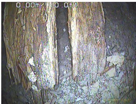
Lahonnutta muottilaudoitusta kaksoislaattapalkistossa
