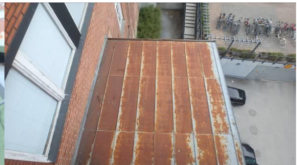
Hissihuoneen vesikate ruostunut
