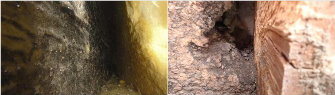
Sokkelin villa oli osittain kiinni betonissa ja osittain irtoi. Sokkelin peltiverhouksen takana korkkia, jonka takana villaa.
