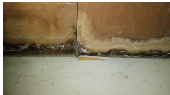
Kevyt väliseinä lahonnut alaosasta
