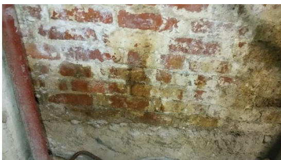
Öljyjäämiä maanvastaisen seinän tiiliverhouk-
