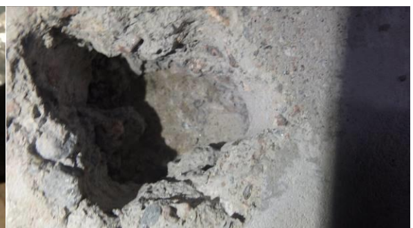
Laajennusosan pintalaatan alla ei havaittu täyttöä
