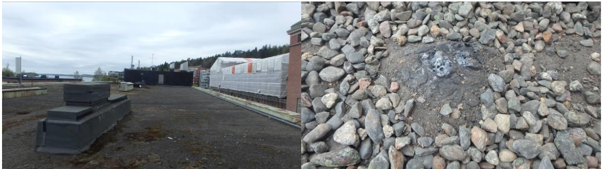
Yleiskuva vesikatosta, kermillä päällystetty van- Ilmakuplia vesikatteessa hoja hormeja
