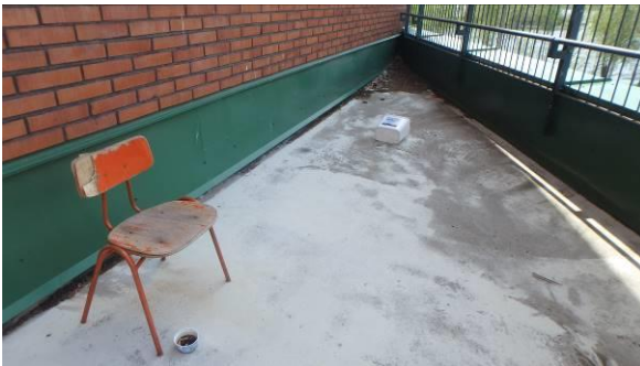
Terassin pellityksiä uusittu, lehtiä ja roskaa ka-
