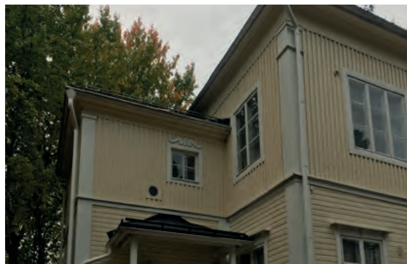
Eteläpäädyn kuisti laajennettiin ja korotettiin vuodne 1990 muutostöissä. Ylä- ja alaosien ulkooverhous vastaa aikaisempien vaiheiden verhousta.
