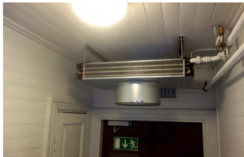
Länsipään vuonna 1927 raennetun kuistin sisäpaneloinnit ovat säilyneet muutostöissä. Katon verhopuhaltimen asennus tapa on paikkaan sopimaton.
