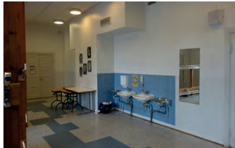
2000-luvun ilmanvaihtokorjaus näkyy aulatiloissa kookkaine hormi- ja kotelorakenteina.
