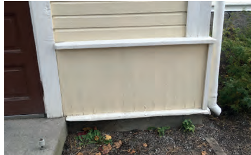
Itäpäädyn kuistin laudoitusta. Laudoitus on paksun maalikerroksen peitossa, mistä voidaan olettaa sen olevan peräisin 1920-luvulta
