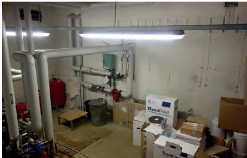
Entinen pannuhuone on nykyään liitetty kaukolämpöverkkoon. Tila on muita kellarin tiloja korkeampi.
