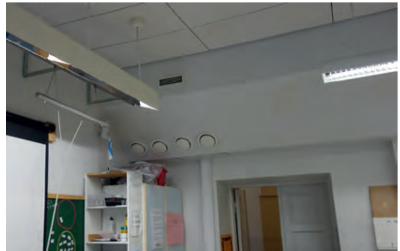
2000-luvun ilmanvaihtokorjauksissa lisätyt vaakakanavat näkyvät huoneitilojen nurkissa kookkaina koteloineina.
