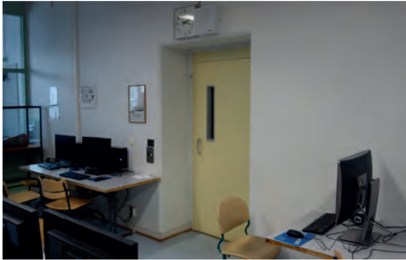
1990 korjauksessa toteutettu hissi
