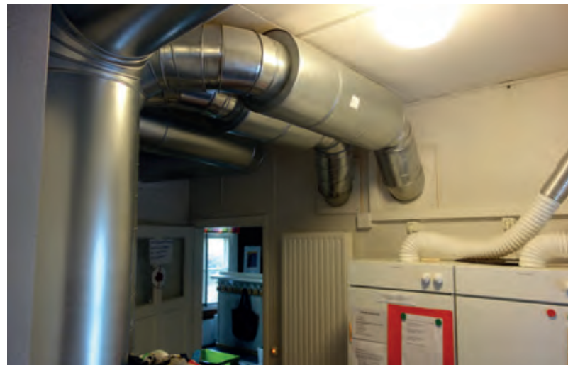
1990-luvun kuistille on asennettu jälkeinpäin tehdyssä IV-korjauksissa uusia IV-kanavia näkyviin. Oikealla esiopetuksen käyttämät kuivauskaapit.
