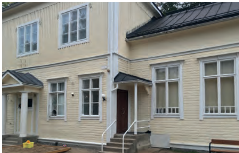
Nivelosan betoniportaait ovat olleet paikalla ainakin vuodesta 1933, mahdollisesti aiemminkin. Suoraan puujulkisivuun liittyvä betonirakenne on riskirakenne.
