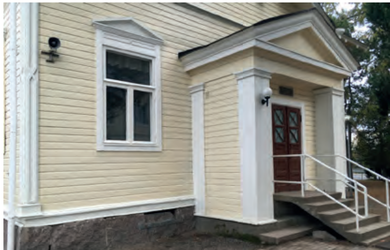
Länsipäädyn kuisti on ajoitettavissa A.E.Eräsén vuoden 1926 muutospii-rustuksiin. Betoninen porras rakennettiin vuoden 1960 muutostöiden yhteydessä suoraan vanhojen päälle.
