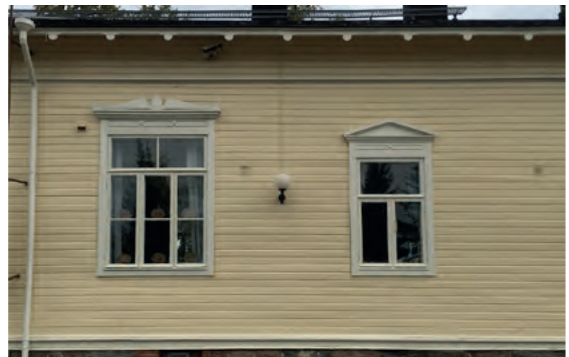
Alkuperöiset sirot ikkunanpuitteet ovat tärkeä osa rakennuksen karaktääriä. Korkeat luokkatilat on merkitty julkisivuihin isoilla ikkuna-aukoilla ja koristeellisimmilla vuorilaudoituksilla.
