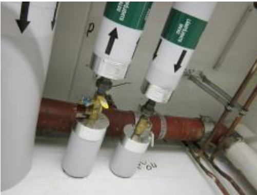
Kuvat 128 a. Maadoittamattomat lämpöputket.
