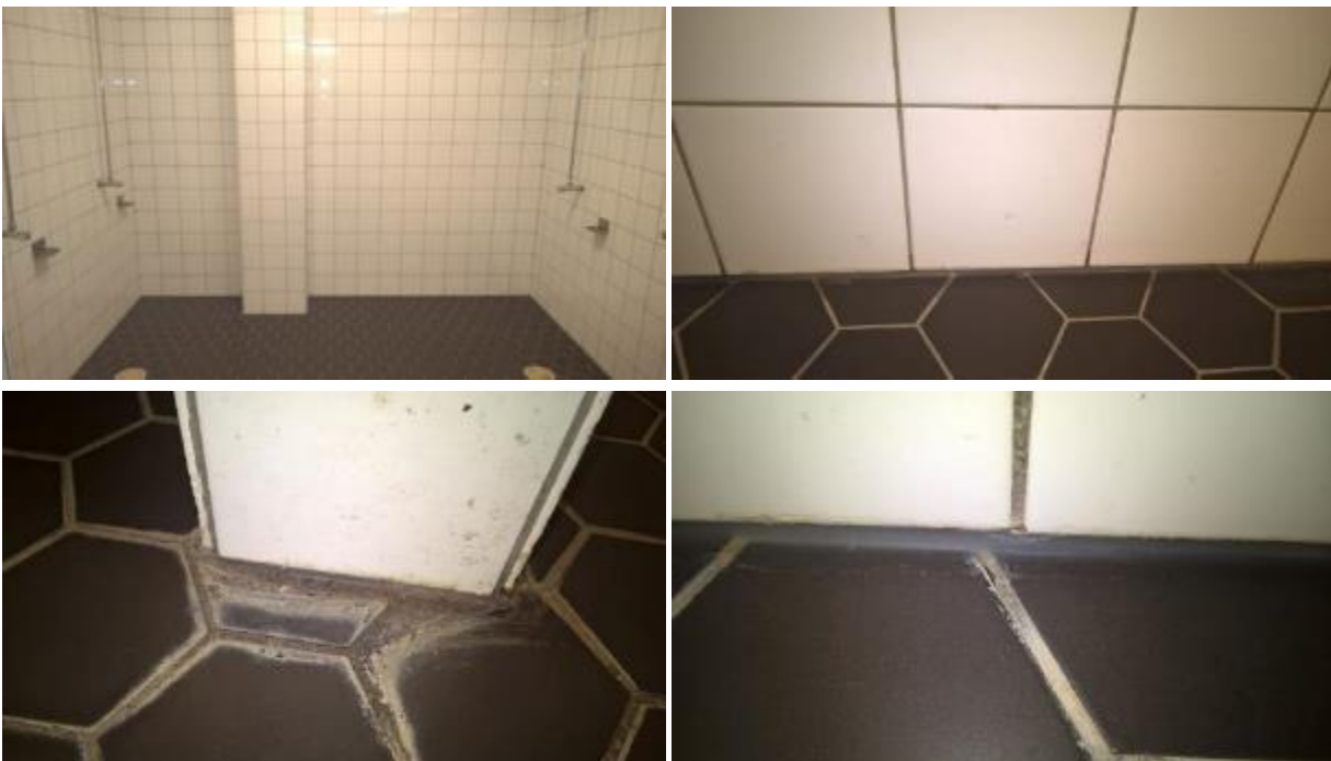
Kuvat 54 a ja b. Pikkusalin yhteydessä olevien märkätilojen mahdollinen vesieristys/kosteussulkukäsittely on pettänyt (suihkun alin laattarivi GANN 60-100, joissain kohdin myös 2.laattarivi)
