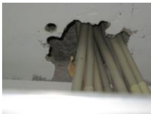
Kuva 119b. Osa läpivienneistä on tiivistämättä.
