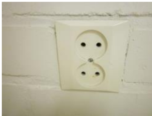
Kuva 131 b. Osassa tiloista on vielä 0-luokan pistorasioita, myös osassa opetustiloja.
