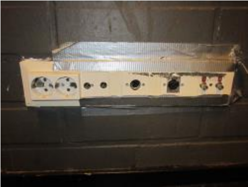
Kuva 179. Pistorasioita on teipattu.
