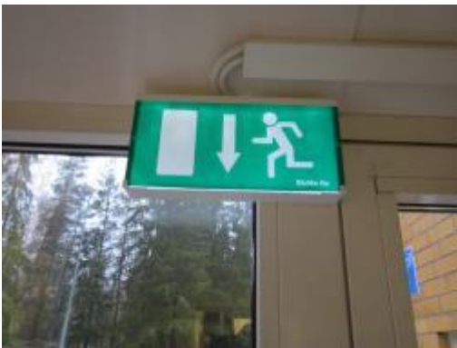
Kuva 146 a. Poistumistievalaisin ulko-ovella
