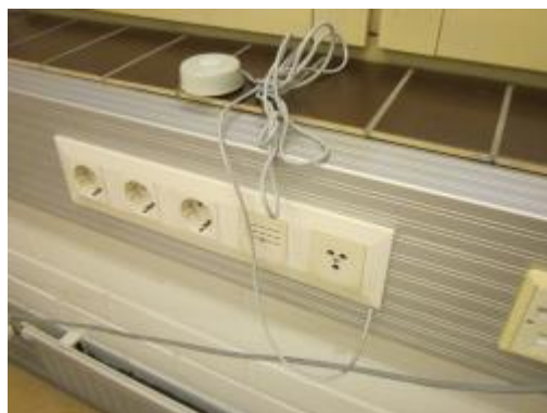
Kuva 142 b. Vanhoja puhelin ja sisäverkko rasioita terveysaseman tiloissa.
