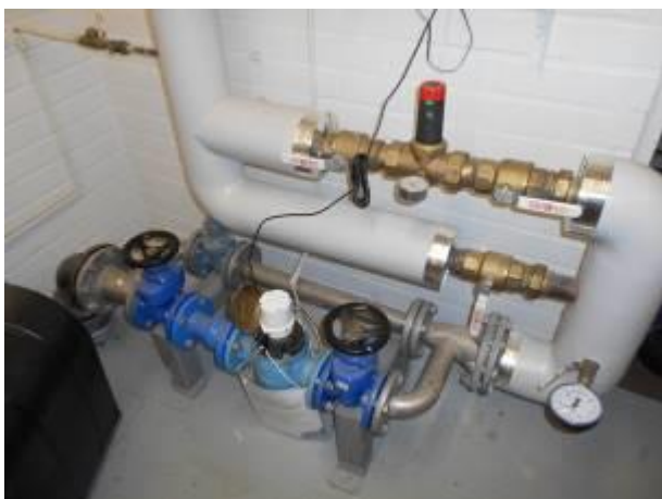
Kuva 195 a. Yleiskuva vesimittarista ljh:ssa.
