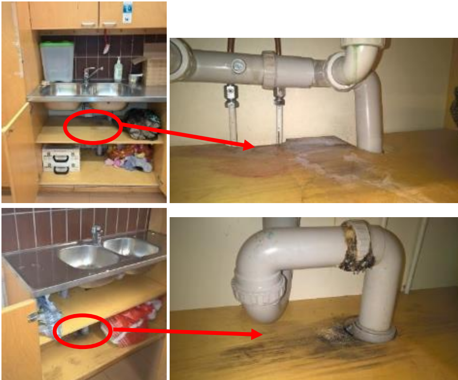
Kuvat 51 a-d. Useissa luokissa havaittiin vesipisteiden aiheuttamia vaurioita kiintokalusteissa. Esimerkkikuvat luokista 1023 (a ja b) ja 2095 (c ja d).
