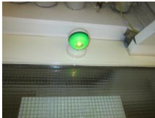
Kuva 146 b. Vanha poistumistievalaisin.
