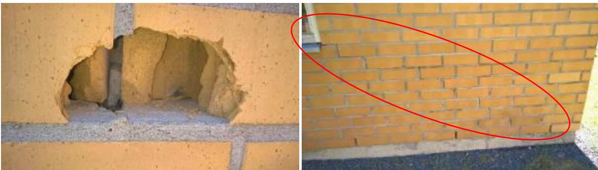
Kuvat 12 a ja b. Tiilistä lohjennut pala (a). Tiiliverhouksessa halkeamaa (b).
