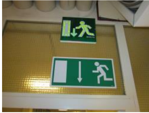
Kuva 145 b. Led-valoilla varustettu poistumistievalaisin.
