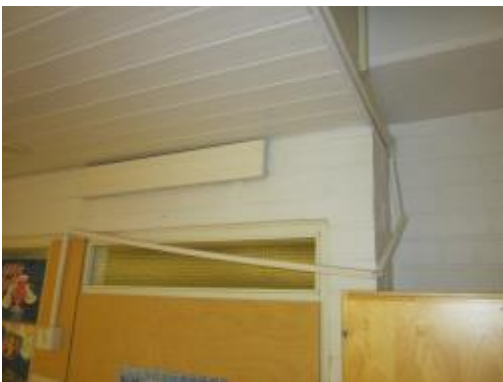
Kuva 160. Listat ja johdot roikkuvat.
