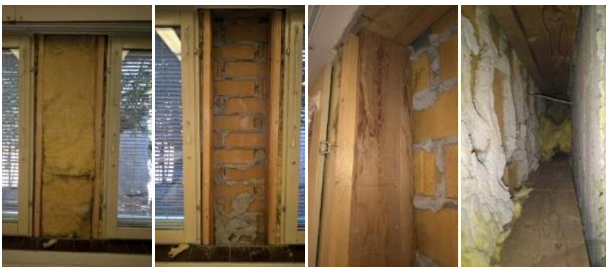
Kuvat 29 a-d. Kuvia luokan 2115 ikkunoiden välisen levytyksen avauskohdasta. "Tuuletusrako" on muurauslaastissa (b). Ikkunanpielitolpissa havaittiin vanhoja valumajälkiä (c). Valokuva välitilasta pystysuoraan alajuoksua kohti (mineraalivilla poistettu ennen kuvan ottamista, (d).
