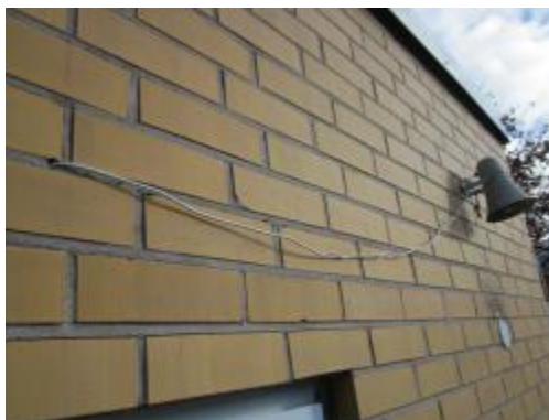
Kuva 153 b. Ulkokaiuttimen johto roikkuu kiinnittämättä ulkoseinällä.
