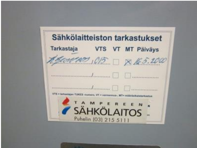
Kuva 118. Tarra määräaikaistarkastuksen suorituksesta pääkeskuksen kannessa
