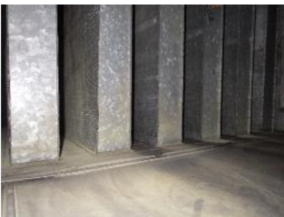
Kuvat 82. Äänenvaimentimet ovat reikäpellitettyä mineraalivillaa.
