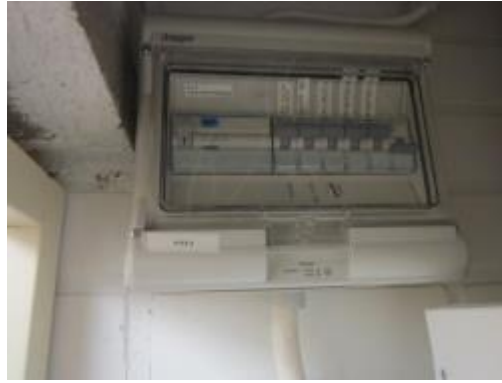
Kuva 124b. Keittiön keskukselle lisättyjä vikavirtasuojattuja lähtöjä.
