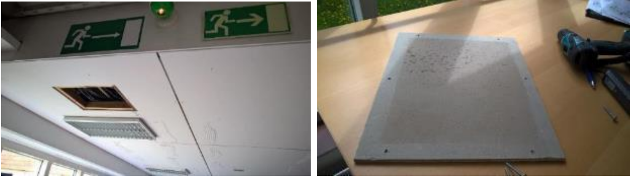
Kuvat 69 a ja b. Akustiikkalevyjen liimajäämiä ei ole poistettu alaslaskulevyistä. Tälle lienee syytä kuitusementtilevyjen mahdollinen asbesti.
