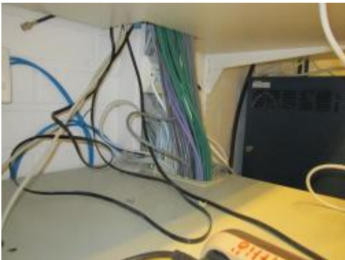
Kuva 134 a. Johtoreitit ovat paikoin täynnä.
