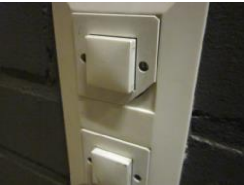
Kuva 180. Valaistuksen ohjaimet rikkoontuneet.
