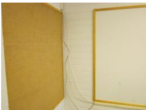
Kuva 178. Johtoja ei ole kiinnitetty seinään.
