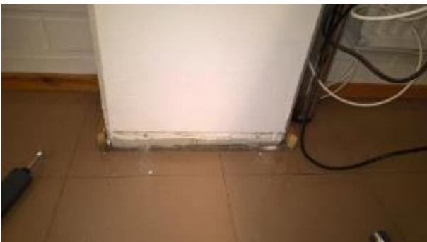
Kuvat 21 a ja b. Joidenkin pilareiden juurella havaittiin maakellarimaista hajua ja lievää kosteuden nousua.
