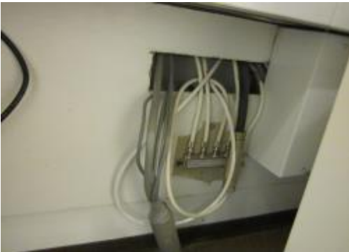
Kuva 141. Haaroin käytävän ryhmäkeskustilassa.
