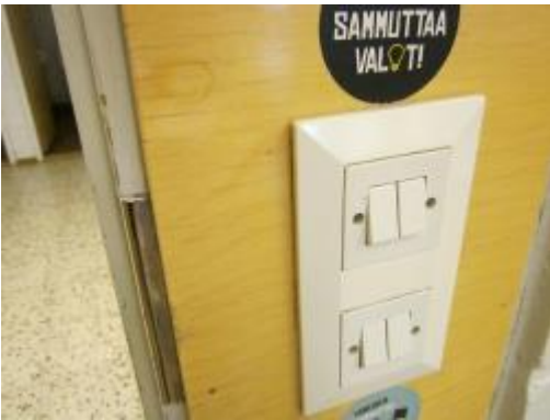
Kuva 183. Valokytkimet ovat irti.
