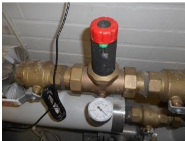
Kuva 195 b. Verkkoston veden paine 3 bar.
