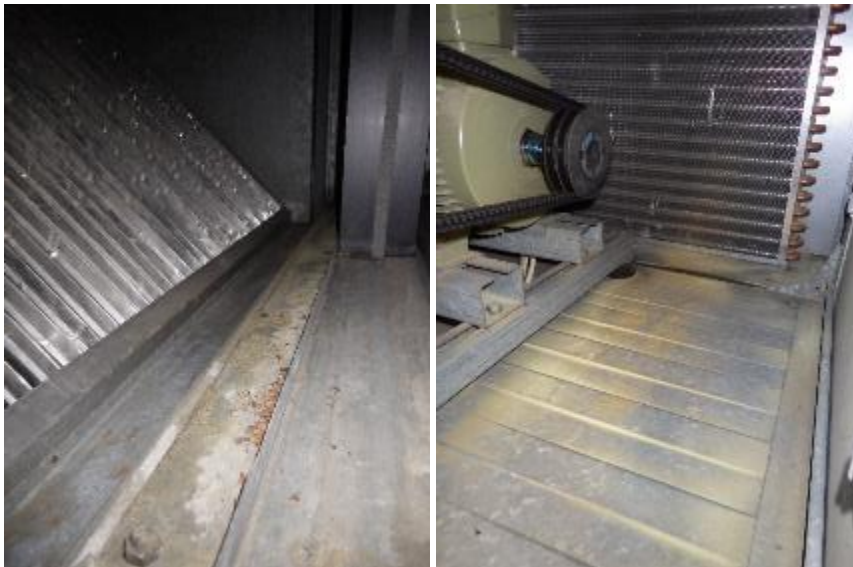
Kuvat 83 a ja b. Suodatin- ja puhallinkammioissa on monen koneen osalta likaa/siitepölyä.
