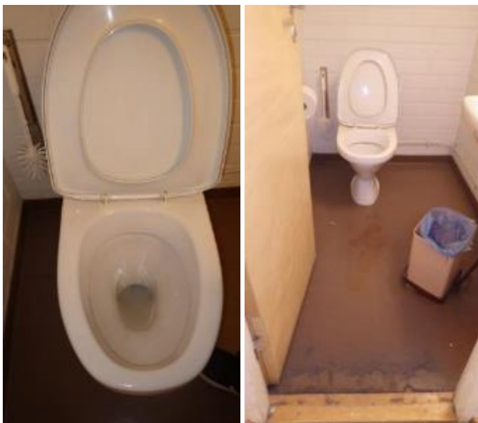
Kuvat 50 a ja b. Yläasteen teknisten töiden läheisistä wc-tiloista kaksi on lukittu ulkopuolelta. Ko. wc-tiloissa havaittiin runsaasti pölyä ja kuivuneet wc-istuimet, jotka saattavat aiheuttaa hajuhaittaa lähialueelle.
