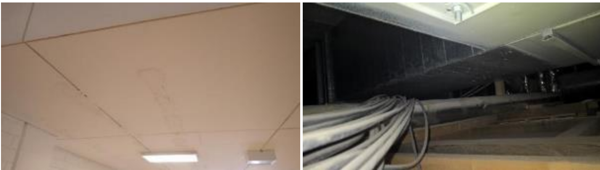
Kuvat 36 a ja b. Alakattojen sisällä havaittiin pölyä.
