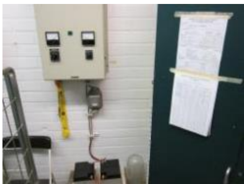
Kuva 144 a. Turvavalokeskus, akusto ja kunnossapito-ohjelma pääkeskushuoneessa.
