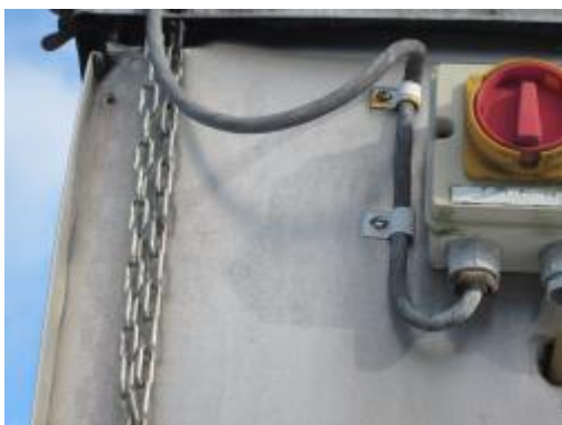
Kuva 136 a. Huippuimurin liitosjohto on pahasti haurastunut. Johto tulee vaihtaa pikaisesti!
