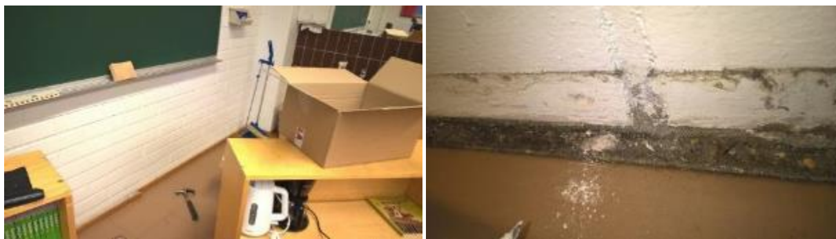
Kuvat 19 a ja b. Väliseinien liitoskohdissa ei havaittu viitteitä maaperäyhteydestä, eikä kosteuden nousua tiiliväliseinien alaosissa.
