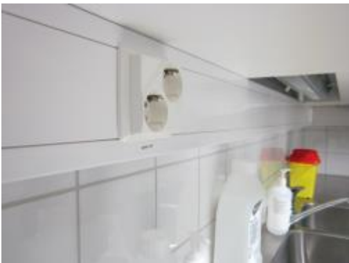
Kuvat 135 a. Terveysaseman tilojen saneerattuja asennuksia, merkinnät selkeät.
