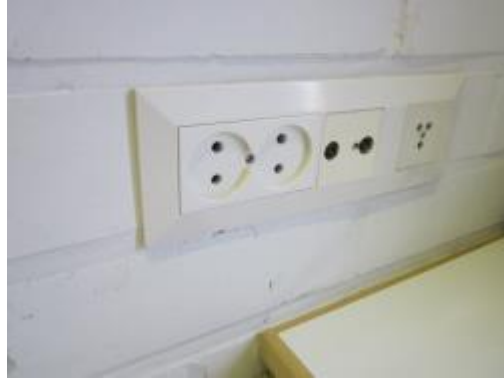
Kuva 140 b. Antennirasiointi opetustiloissa.
