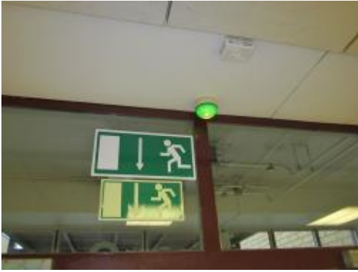
Kuva 145 a. Poistumistiekylttejä on lisätty poistumistievalaisimen yhteyteen.
