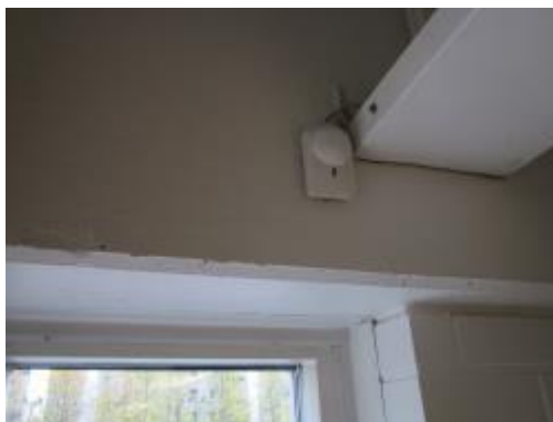
Kuva 148 b. Liikeilmaisimien käytävällä.
