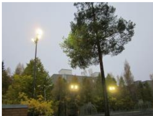
Kuva 139b. Uusittuja tolppavalaisimia.
