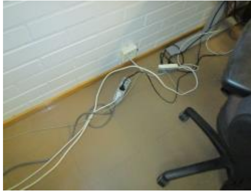
Kuva 133 b. Pistorasioiden vähyys näkyy jatkojohtovirityksin.
