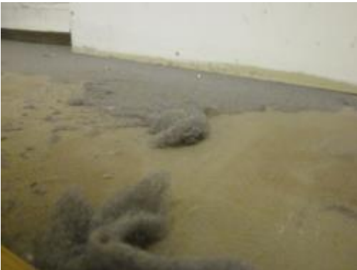
Kuva 173. Pölymatto on keskustilassa paloturvallisuusriski.
