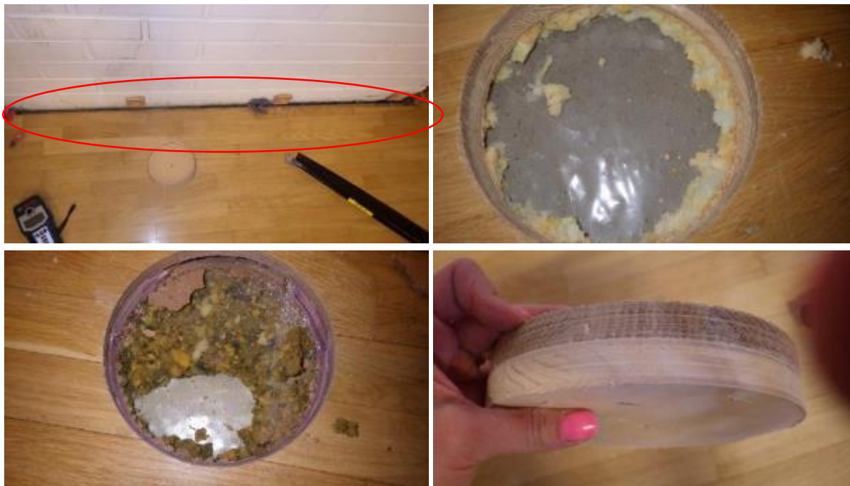
Kuvat 18 a-d. Pesuhuoneen vastaisen väliseinän (pikku Sali) ja alapohjan liitoskohdassa havaittiin voimakas maakellarimainen haju (a). Liikuntasalien rakennevausten yhteydessä vaahtomuovikerroksen alapinnassa havaittiin ummehtunut/mikrobiperäinen haju.
