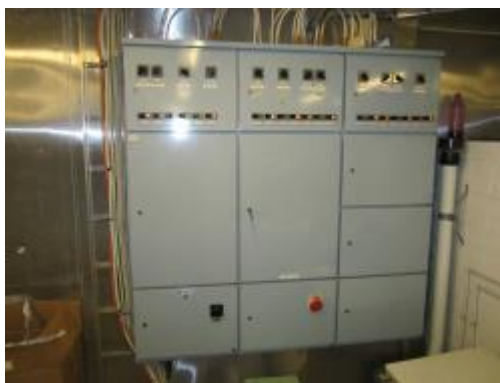
Kuva 136 b. IV-konehuoneen vanha keskus.
