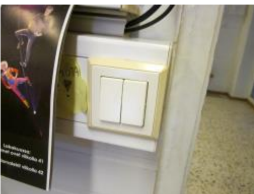
Kuva 187. Kytkin ei toimi kunnolla.
