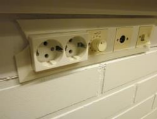
Kuva 164. Peitelevy on rikkoutunut.
