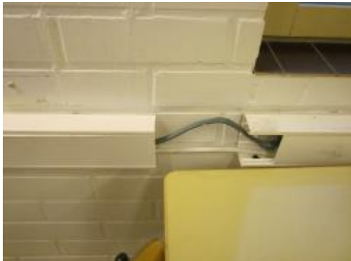
Kuva 170. Kourusta puuttuu osa.
