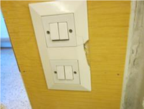
Kuva 185. Peitelevy on rikkoutunut.
