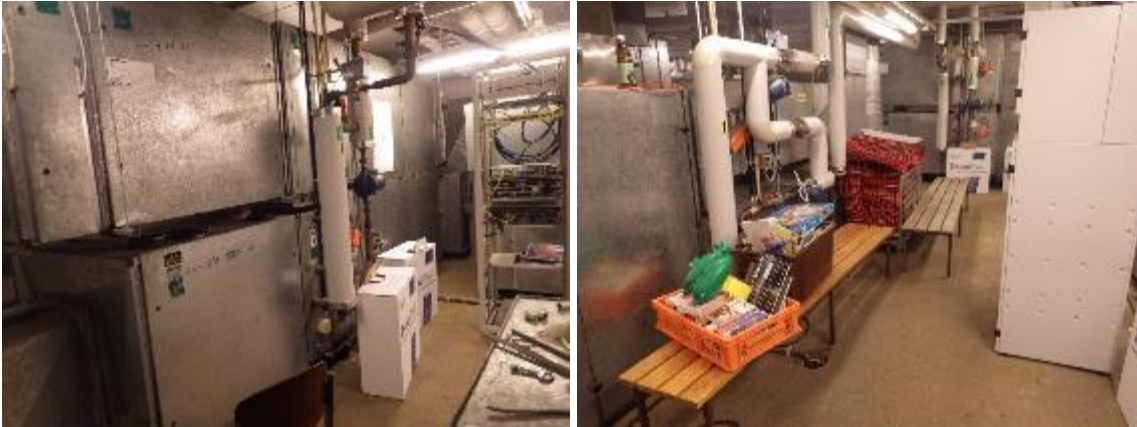
Kuvat 77 a ja b. Esimerkki rakennuksen tulo-/poistoilmanvaihtokoneesta (TK3/PK3) (a). Ilmanvaihtokonehuoneissa säilytetään tavaraa (b).
