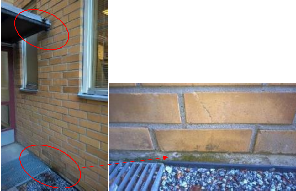
Kuvat 7 a ja b. Puutteellinen katoksen sadevedenohjaus on todennäköisesti yhtenä tekijänä luokan 1017 ulkoseinän merkittävimmissä kosteusvauriokohdassa.
