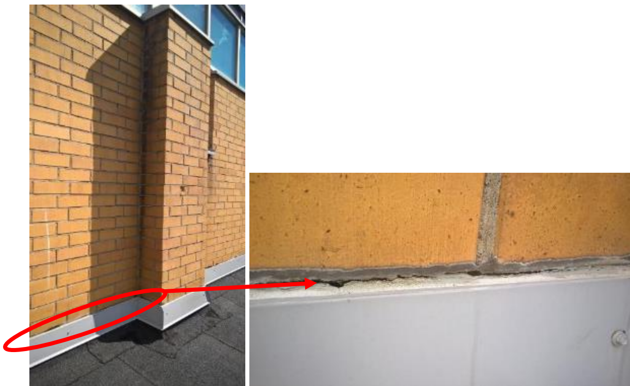
Kuvat 39 a ja b. Vesikaton porrastusten ylösnoston/pellityksen saumauksissa havaittiin epätiivelyskohtia.
