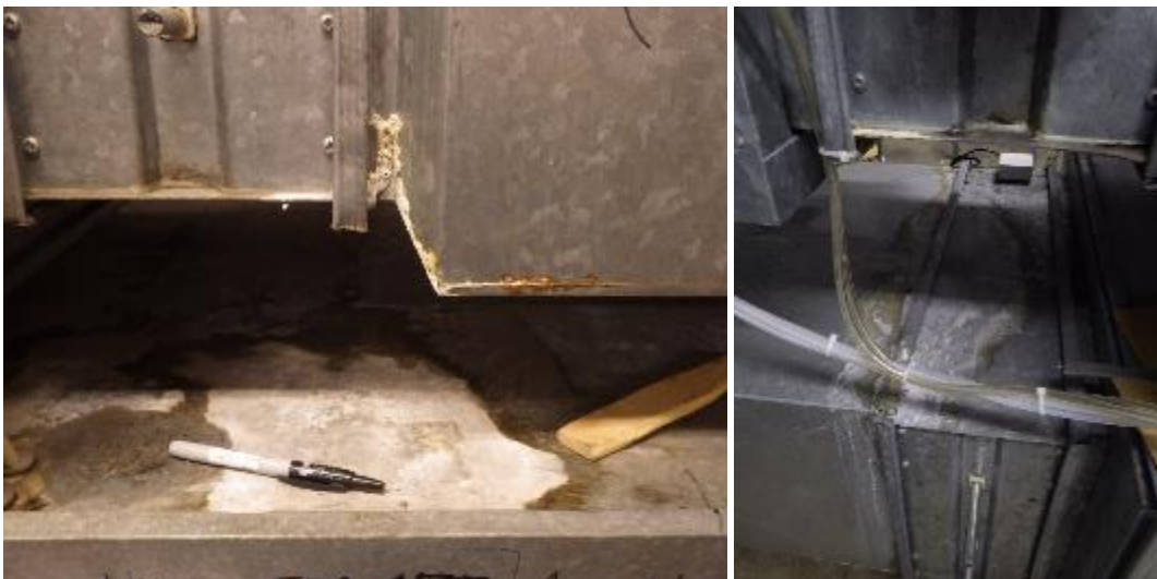
Kuvat 79 a ja b. Useassa ilmanvaihtokoneessa havaittiin vesivuotojälkiä.
