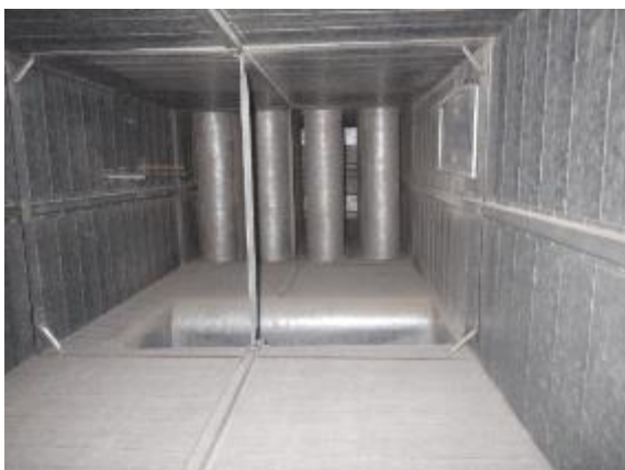
Kuvat 84. Jotkin tuloilmakanavat koneen jälkeen olivat puhtaita.
