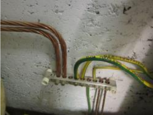
Kuva 127a. Maadoituskisko pääkeskuksella.
