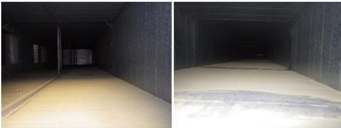
Kuvat 88 a ja b. Kanavistossa havaittiin siitepölykertymää pistokoemaisessa tarkastelussa.
