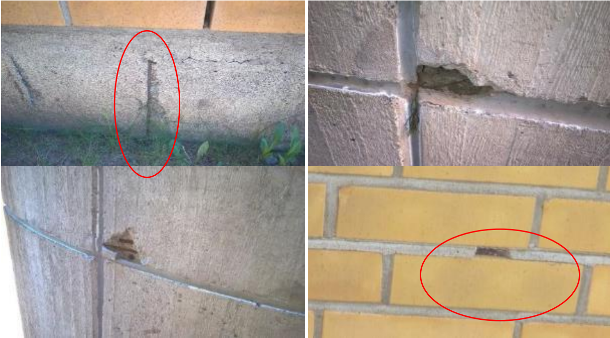
Kuvat 11 a-d. Rakenneteräksiä havaittavissa sokkelissa ja tiilen saumoissa.
