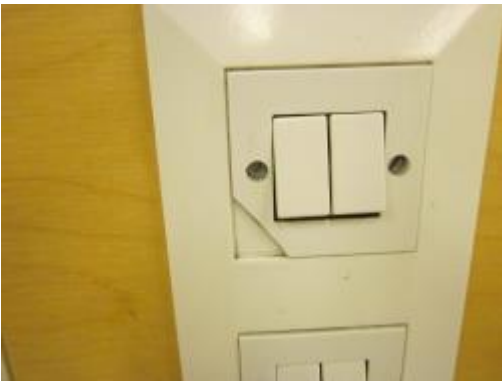
Kuva 165. Peitelevy on rikkoutunut.
