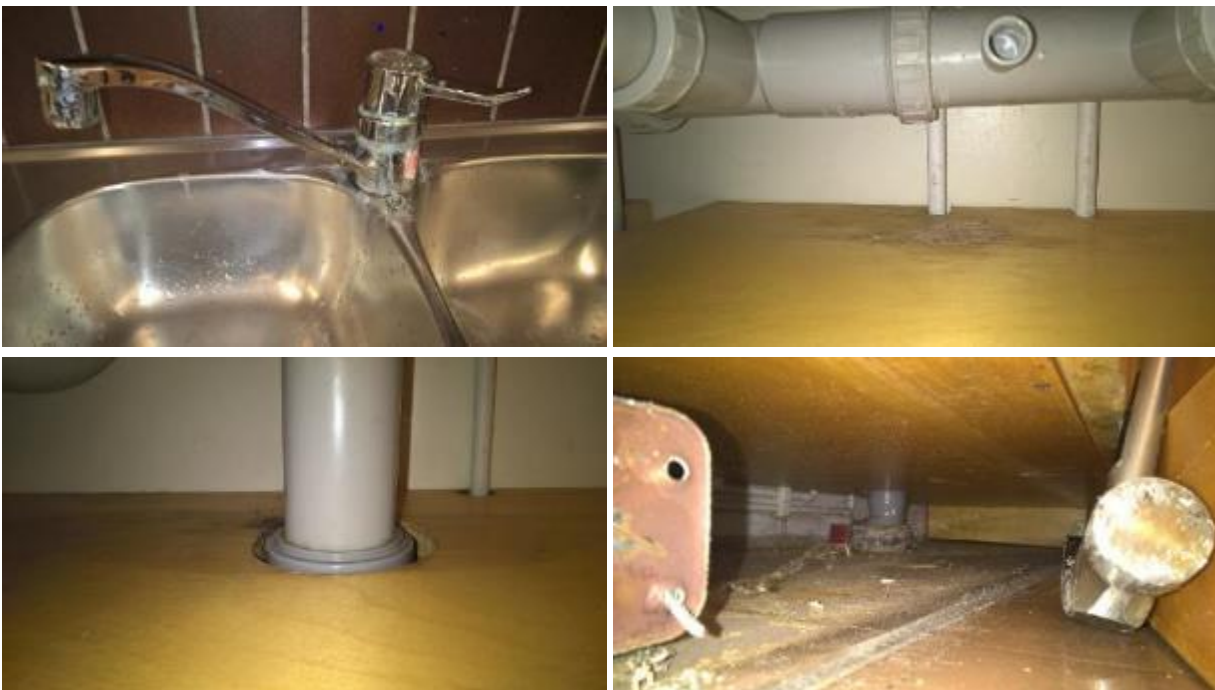
Kuvat 52 a-d. Useissa luokissa havaittiin vesipisteiden aiheuttamia vaurioita kiintokalusteissa. Esimerkkikuvat luokasta 2115, jossa vettä on vuotanut liitoskohdasta aiheuttaen jälkeä puutasoihin ja kaapin alla havaittiin kosteutta sekä runsaasti likaa.
