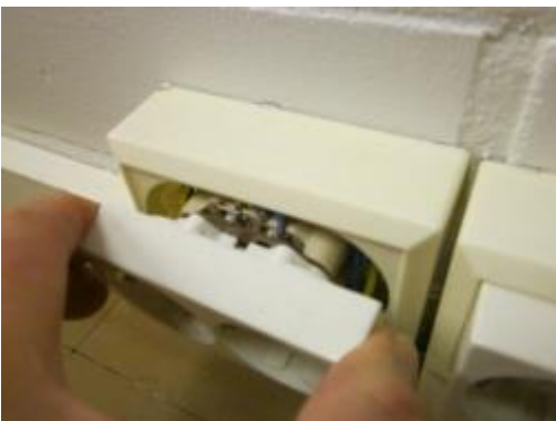
Kuva 190. Pistorasia on irti pohjastaan.
