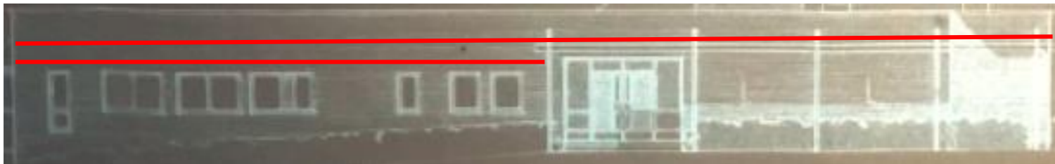
Havainnot kaakkoisjulkisivulta. Punaisilla viivoilla on merkitty halkeamat tiiliverhouksen laastisaumoissa.
