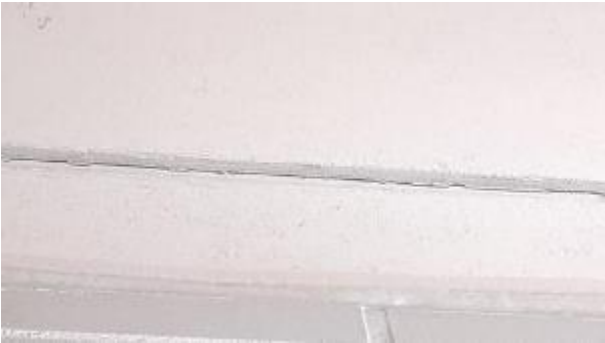
Kuvat 43 a-c. Yläpohjan ontelolaattasaumoissa havaittiin halkeamia.
