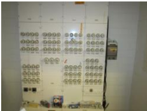
Kuva 123a. Teknisentyön tilojen keskus ja lisätty vikavirtasuojat kattopistorasioille.
