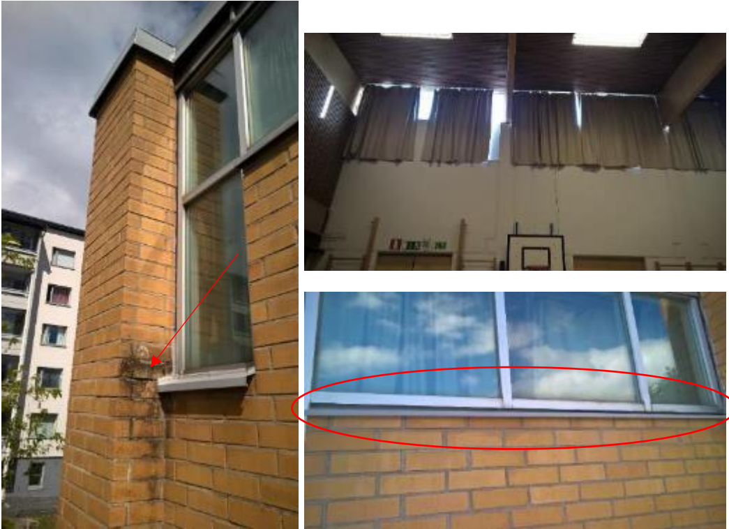
Kuvat 32 a-c. Kosteuden aiheuttamaa jälkeä ulkoseinässä rakennuksen korkealla osuudella/liikuntasalin kohdalla (a). Salin yläikkunoiden alareunasta puuttuu paikoin tiivistys (c).
