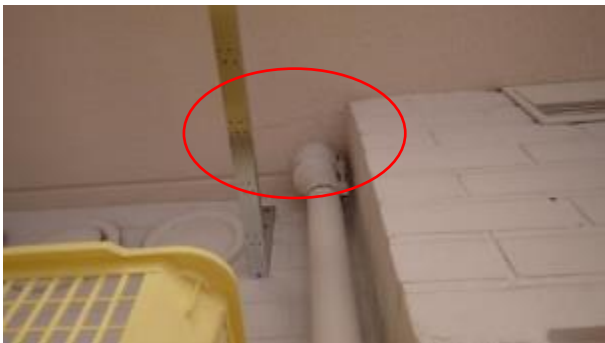
Kuva 41. Joissakin tiloissa on kuivuneita valumajälkiä sadevesiputken ympärillä.
