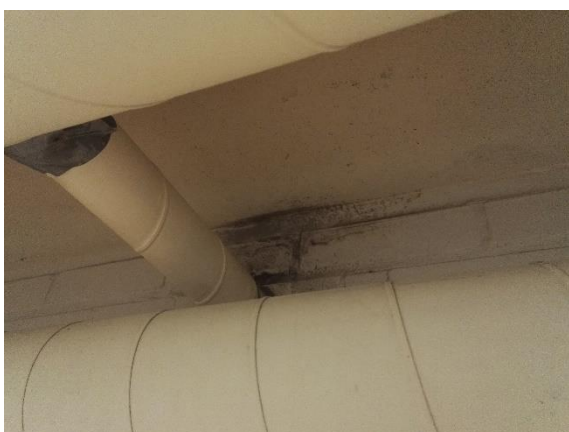
Kuva 86. Ilmanvaihtokanavien läheisyydessä on monin paikoin havaittavissa pölykertymä, mikä viittaa kanaviston vuotoihin.
