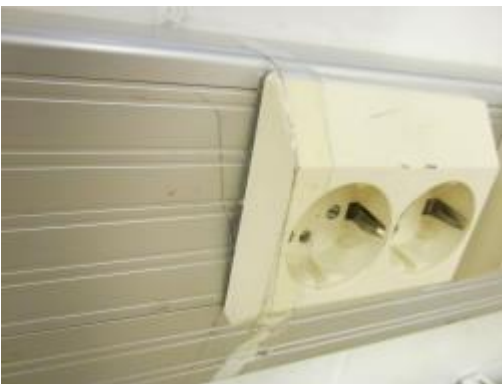
Kuva 168. Pistorasia teipattu kiinni kourun.
