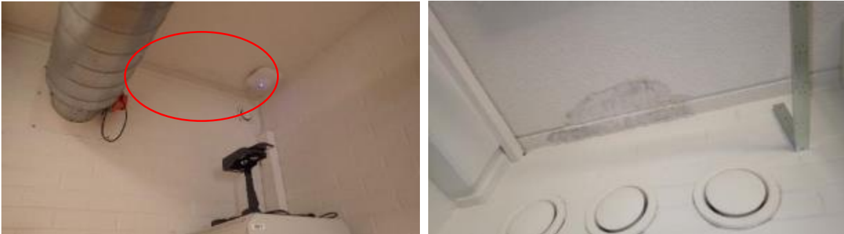
Kuvat 24 a ja b. Tiloissa 1018 (a) ja 1064 (b) välipohjassa havaitut vuotojäljet olivat kuivia pintakosteusilmaisimella.
