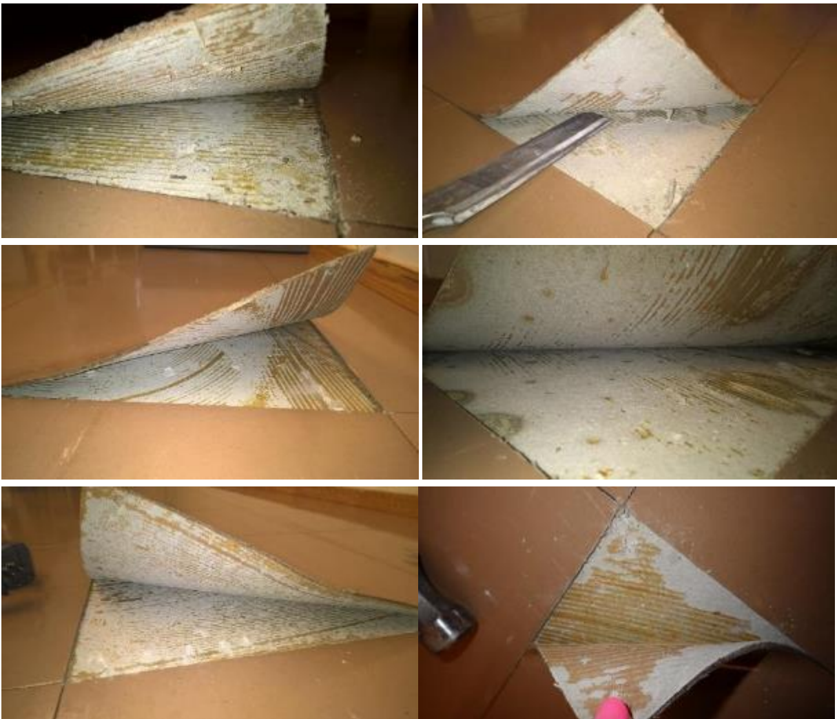
Kuvat 16 e-f. Lattianpinnoitteen alla oli havaittavissa poikkeavaa kemiallista hajua kosteilla alueilla.
