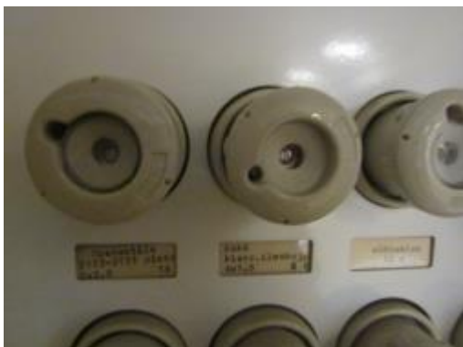
Kuva 176. Sulakekannen lasi puuttuu.
