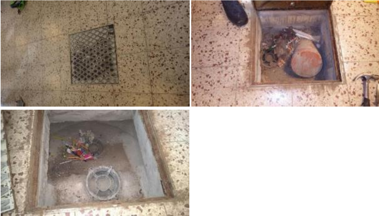
Kuvat 23 a-c. Maanvastaisilla osuuksilla on viemärin tarkastusluukkuja, joihin on kerääntynyt likaa ja roskaa ajan saatossa.
