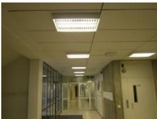
Kuva 129 a. Käytävävalaistus on toteutettu loisteputkivalaistuksella.
