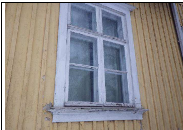
13. Ikkunoissa kunnostus / uusimistarve
