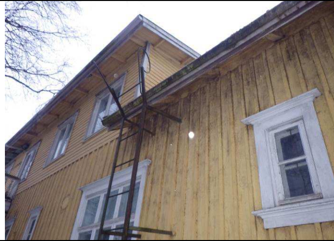
15. Räystäsrakennetta, talotikkaan kiinnitys näyttää huteralta
