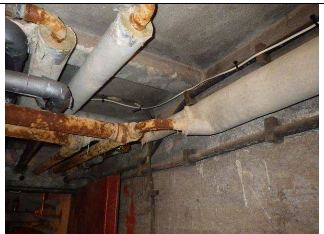
34. Ikääntyneitä lämmitysjärjestelmän putkia, putkieristeissä on todennäköisesti asbestipitoisia materiaaleja
