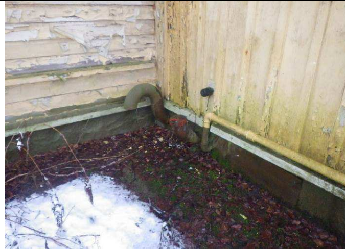
1. Sokkeleissa ja seinien alaosissa näkyy kosteuden aiheuttamia jälkiä / vaurioita
