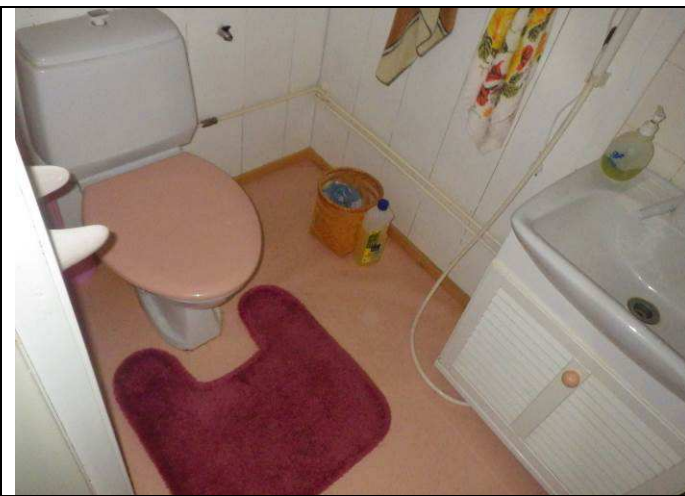
25. Yläkerran wc:ssä on ollut saadun tiedon mukaan vesivuoto
