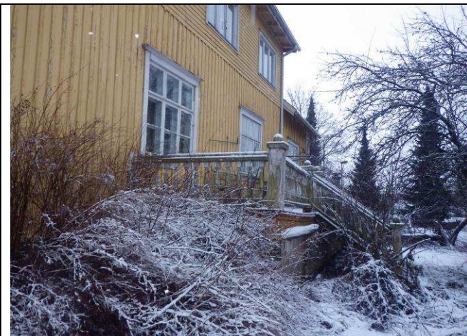
11. Takaterassi on lahovaurioitunut
