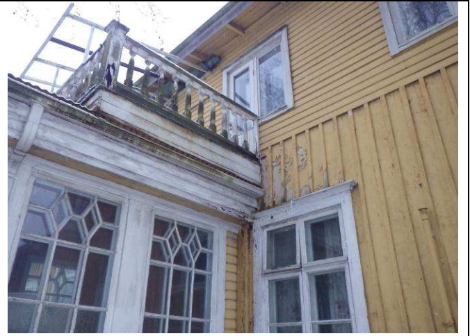
16. Kosteusjälkiä vuotaneen parvekkeen alapuolisissa rakenteissa
