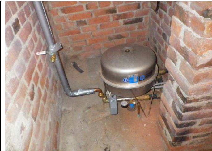
36. Käyttövesijärjestelmän putkistoa ja laitteistoa
