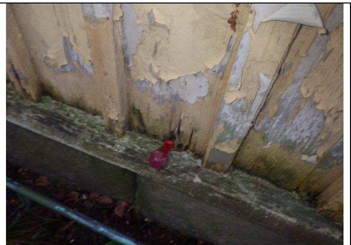
12. Ulkoseinien alaosissa havaittiin kosteus- ja lahovaurioita
