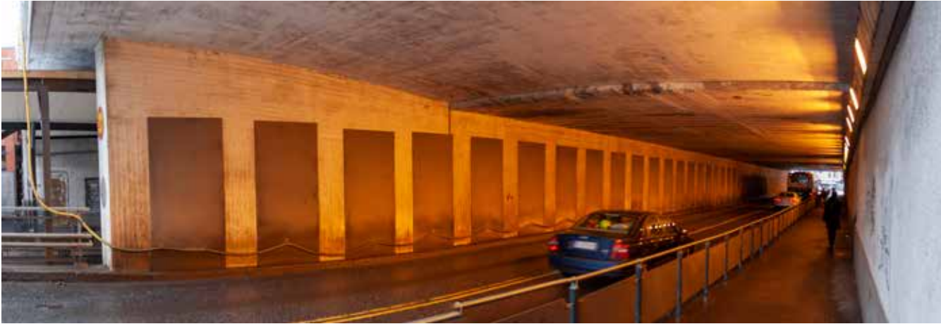
Tunnelin keskivälin pendelpilarit. Pilareiden väliset aukot on levytetty väliaikaisesti eteläisen puolen työmaan ajaksi. Huomaa kai- tein erotettu kevyen liikenteen väylä oikealla ja viimeisimmän tunnelin pidennyksen ja rata-alueen levennyksen rajapinta katossa ja pendelpilaristossa.
