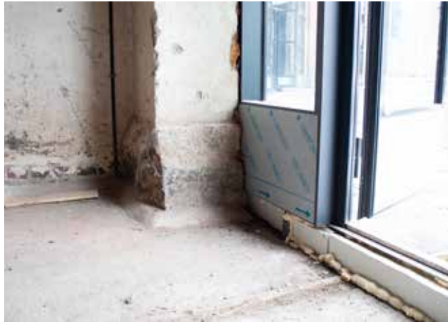
Kivinen antura/sokkeli, päällä tiilimuuraus. Uudessa ikkuna-seinässä kiireinen työn jälki: suojamuovit jätetty sisäpuolelle, saumat viimeistelemättä.
