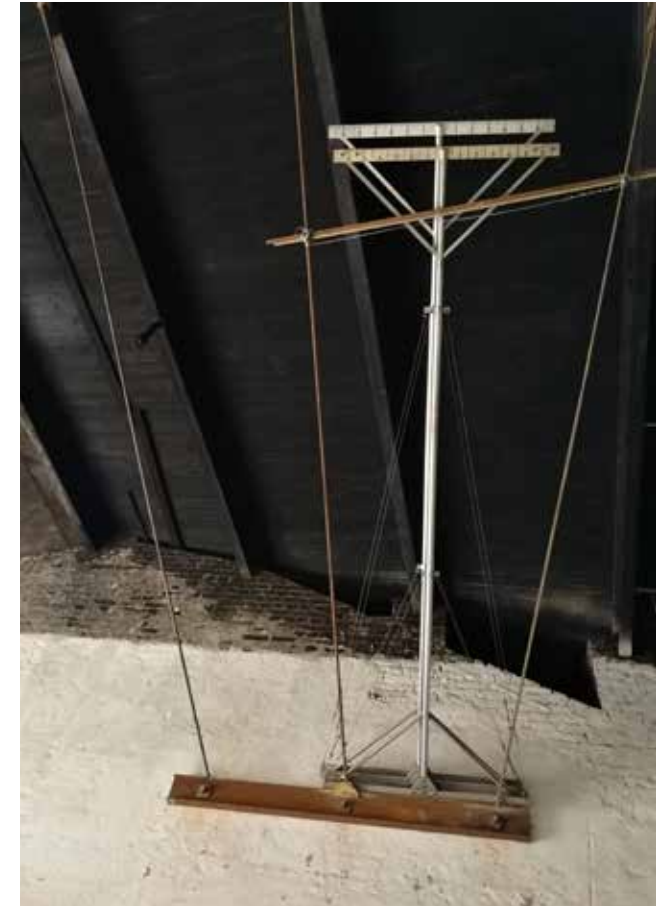
Pilttuu 4:n pilarinosturin tuennan vetotangot hitsattu katon teräspalkkeihin. Vetotankojen päällä kaksi pitkää keskitysmittaa.
