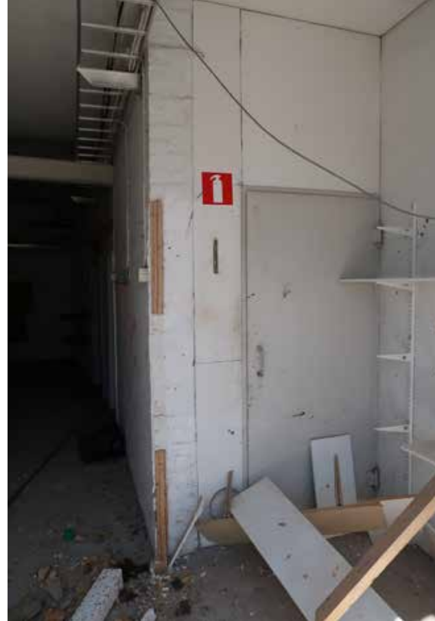
Toiseen kerrokseen johtavan portaan teräspalo-ovi.
