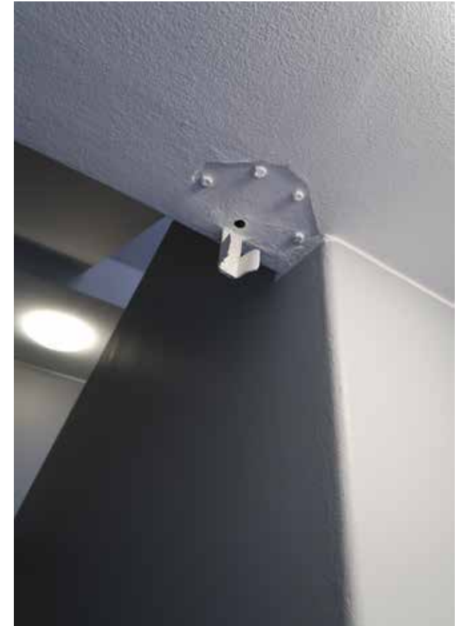
Portinrajoitin välipohjan alapinnassa.
