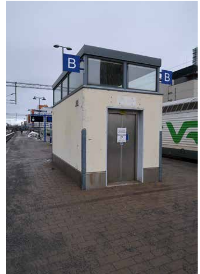
Asematunnelin hissitorni 1988-89. Tornissa on otettu huomioon ensimmäisen välilaiturin arkkitehtuuri toisin kuin laiturin porraskatoksessa. Vaaleankeltainen pintamaali on osin lohjennut, kunto välttävä. Huomaa yläikkunat.
