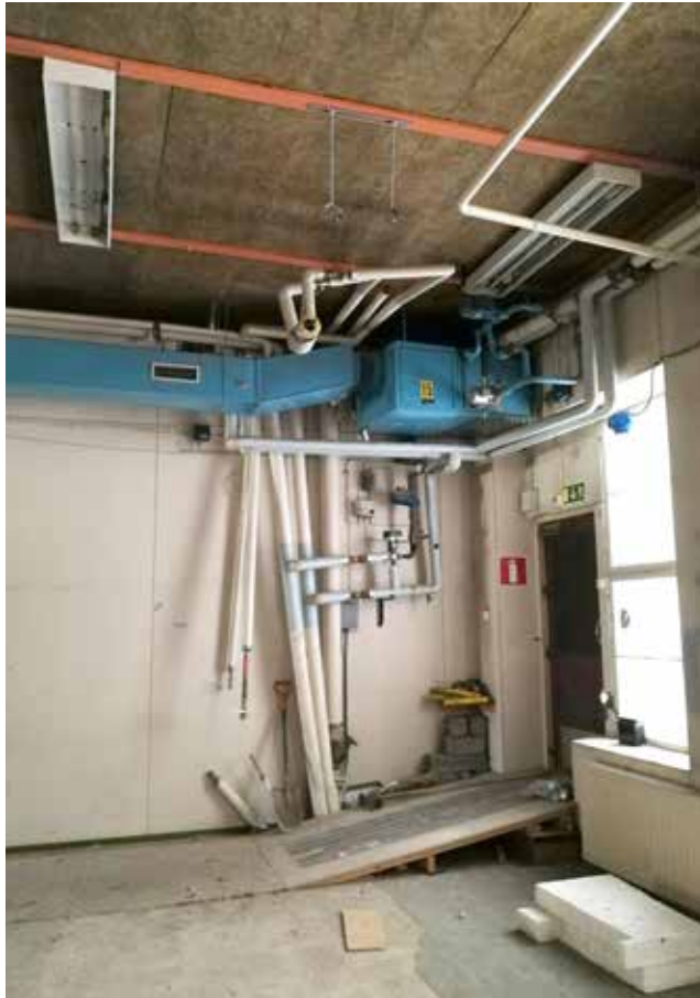
Takaseinän ikkunan läpi avattu poistumistieovi rampeineen. Sosiaalitilavaiheen ilmanvaihtolaitteistoa. Uusimmissa lämpölinjoissa harmaa muovikuori eristeen päällä.
