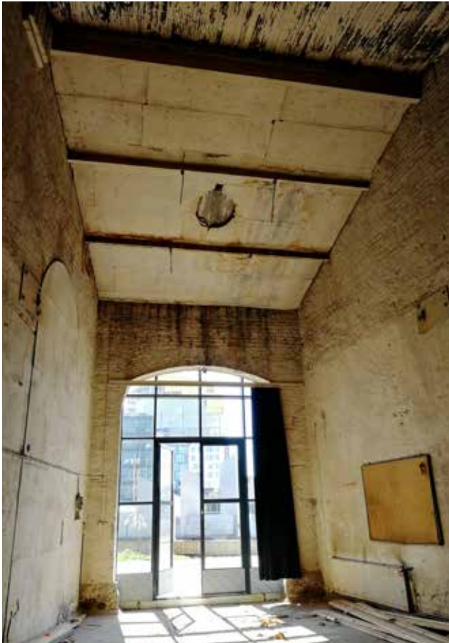
Katon etulapteen levytystä. Pyöreä reikä katossa on tallissa olevan höyryveturin savupiipun kohdalla savunpoistoa varten. Vastaava reikä löytyy pilttuu 5:n katosta, jossa on myös nokeentunut kattolaudoitus.
