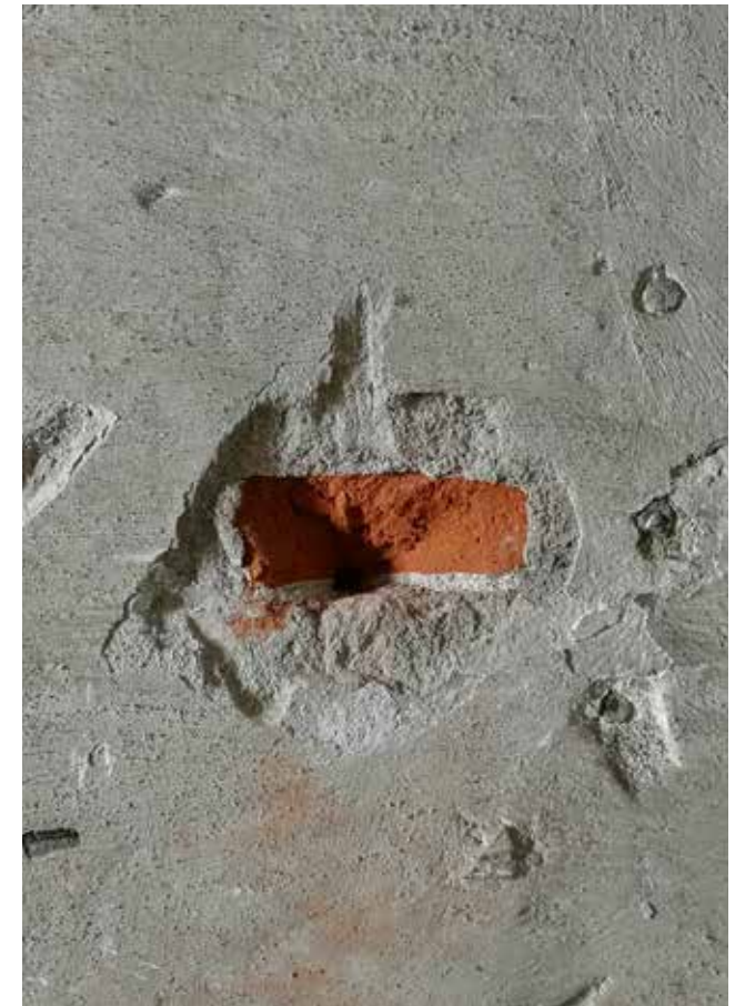
Pilttuun seinän rappausta ja paljastunut punatiili.
