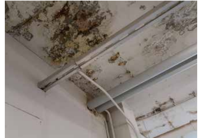
Varaston laiturinpuoleinen seinä ja välipohja. Kosteus puskee läpi maanvastaiselta seinältä myös muissa kellarikerroksen tiloissa.
