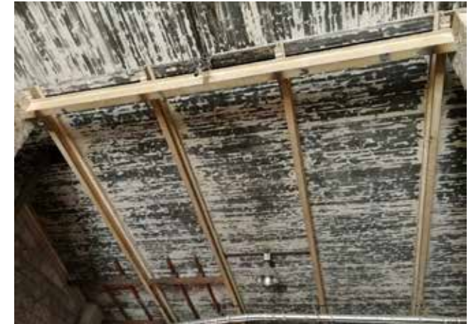
Pilttuun 4 vastaisia ummistettuja kaariaukkoja. Huomaa myös näkyvissä oleva alkuperäinen vuoden 1886 kattolinja, jonka yläpuolella aukkojen ummistus muuraamalla. Veturiastian puoleinen alakaton paloeristys puuttuu muun alakaton alueelta.
