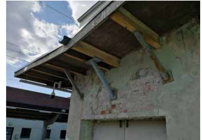
Katoksen päädyn seinään kiinnitetyt vinotuet. Katosta on lyhennetty tästä päädyistä noin 5 m Matkakeskustunnelin rakentamisen yhteydessä 2008.
