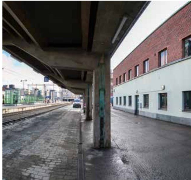
Katoksen pilareihin upotetut kupariset syöksytorvet. Huomaa asemarakennuksen julkisivu ja tiiliverhottu vuoden 1948 lisäkerros. Sokkelikivilaatat ovat alkuperäiset.
