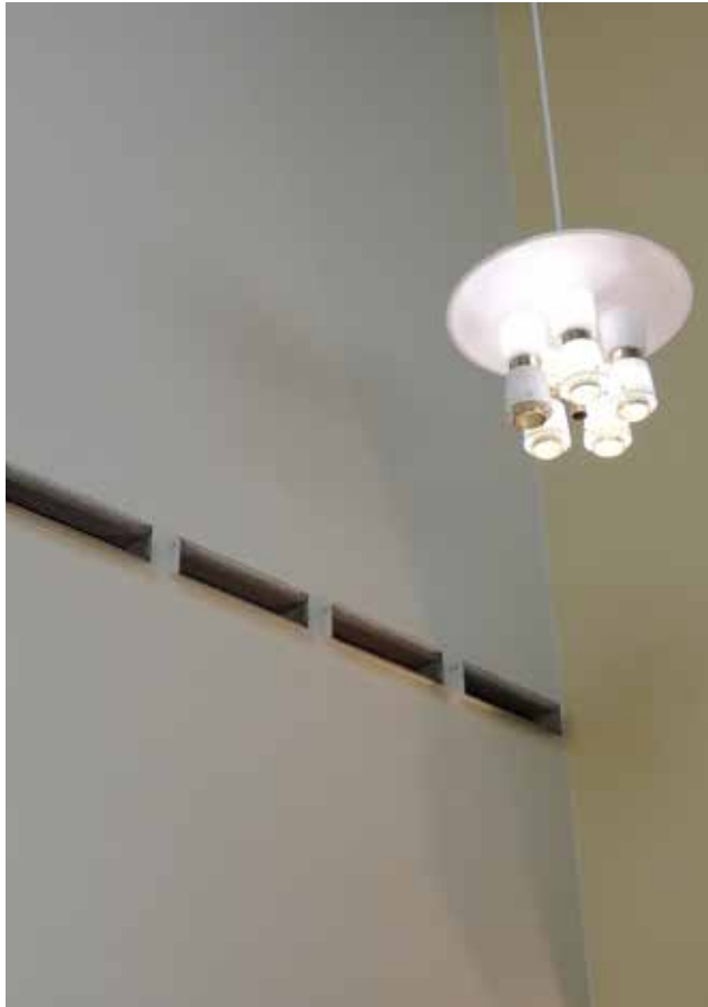
Lähikuva kattolampuista ja ilmanvaihtorilöistä.
