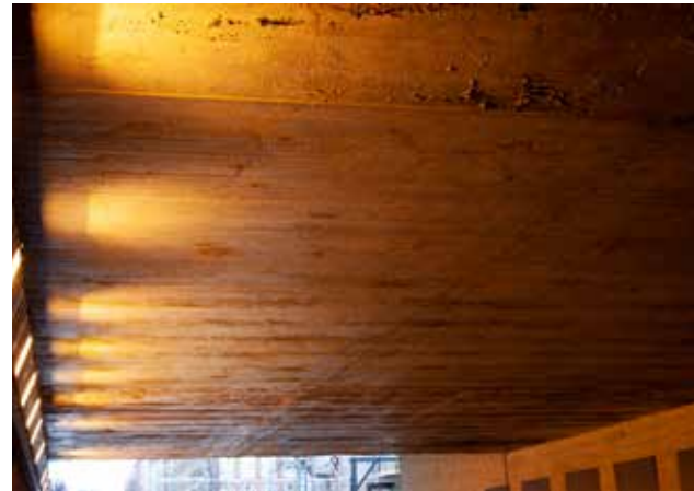
Tunnelin katon pintaa. Maali hilseillyt paikoin.
