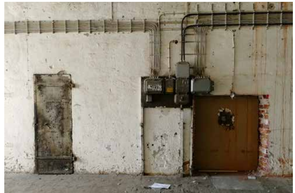
Pilttuissa on jäljellä vanhoja sähköasennuksia ja pieniä palo-ovia alkuperäisissä umpiseinissä.
