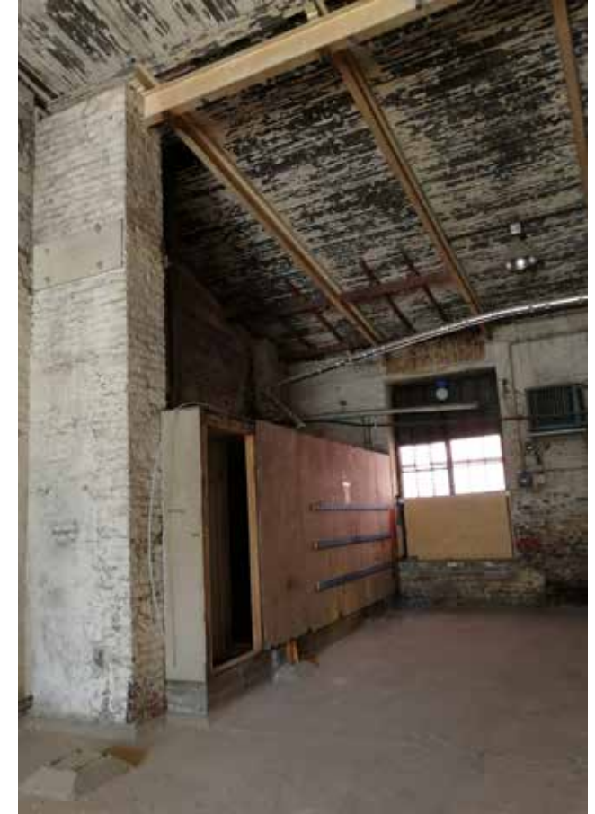
Pilttuu 2:n sosiaalitilojen laajennus Pilttuu 3:n puolelle. Varastokäytössä olleen tilan seinästä puuttuu levy.
