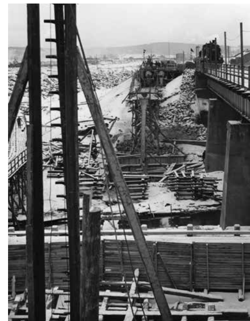
Viinikanojan nykyisen sillan toinen puoli rakenteilla 19.3.1939. Juna kulkee jo valmiilla sillan puoliskolla. Kuva Museokeskus Vapriikki.
