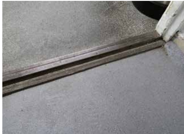
Panssaribetonilattian ja keittiöpuolen laitoskeittiömuovimatons välinen kynnyks
