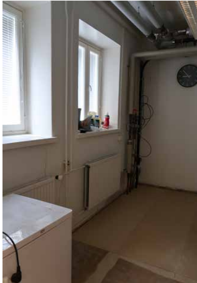
Vesivahingon vuoksi pois käytöstä oleva taukotila sisäänkäynnin länsipuolella pohjakerroksessa.
