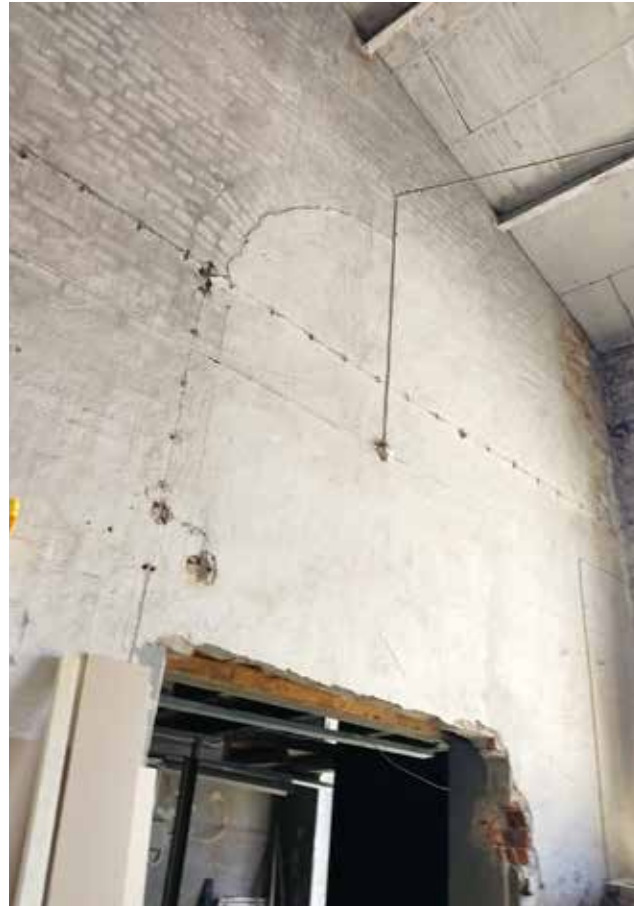
Oviaukko pilttuu 8:aan. Yläpuolisesta muurauksesta puuttuu kannatus.
