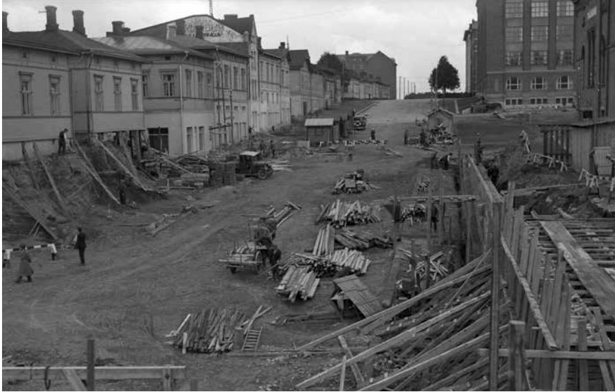
Itsenäisyydenkadun tunnelin rakennustyömaa 1933. Itsenäisyydenkadun (siloisen Puolimatkan kadun) korkoa oli madallettava hyvin pitkältä matkalta. Kuva Vapriikin kuva-arkisto, kuvaaja Veikko Kanninen.
