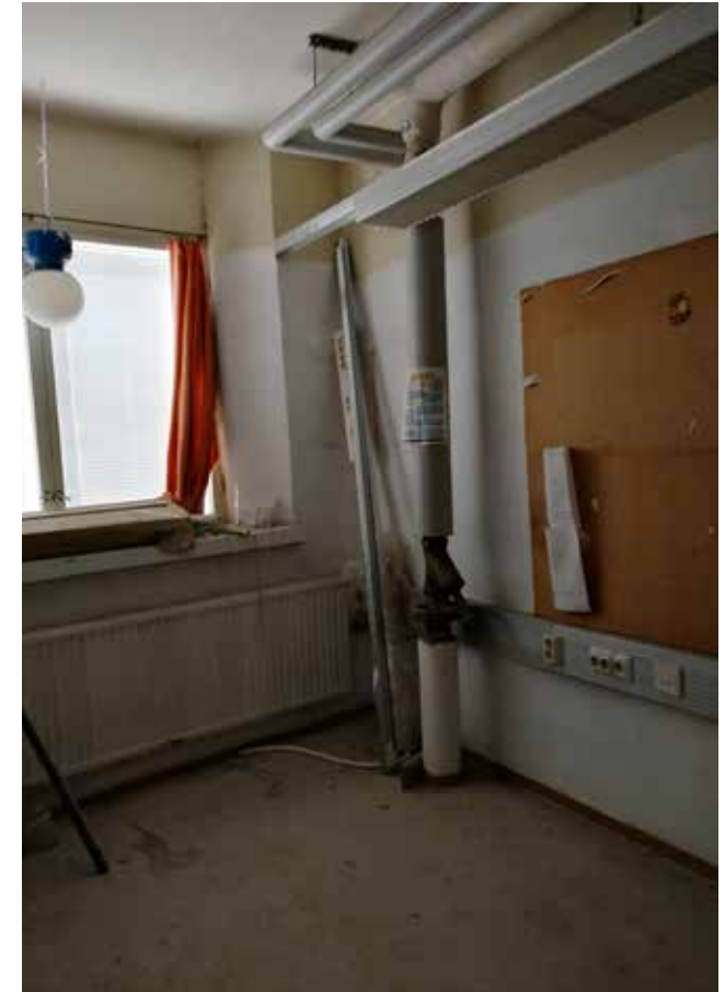
Toimistohuone. Uusia ja vanhoja putkilinjoja.
