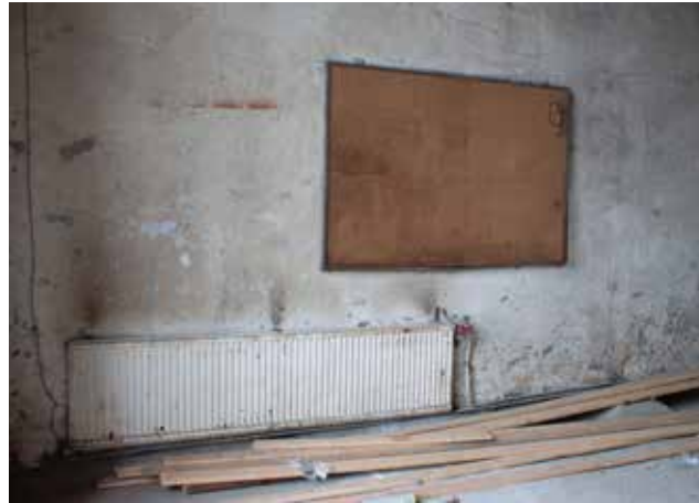
Veturitaliin on jossain vaiheessa lisätty keskuslämmitys. Kuvan lamellipatterissa on raudoin suojattu termostaatti.
