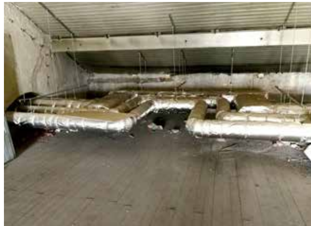
Lämpölinjat toisessa kerroksessa.
