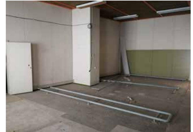
Pukutila, pukukaappien kuivatuspatterit lattiassa.
