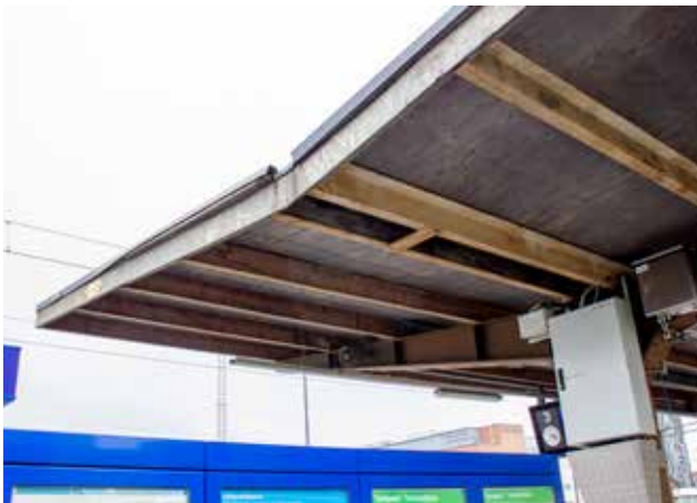
Laiturikatoksen pääty. Pellitys, filmivanerialuskate, Z- ja laip-pateräspalkit. Asemalaitteistoa.
