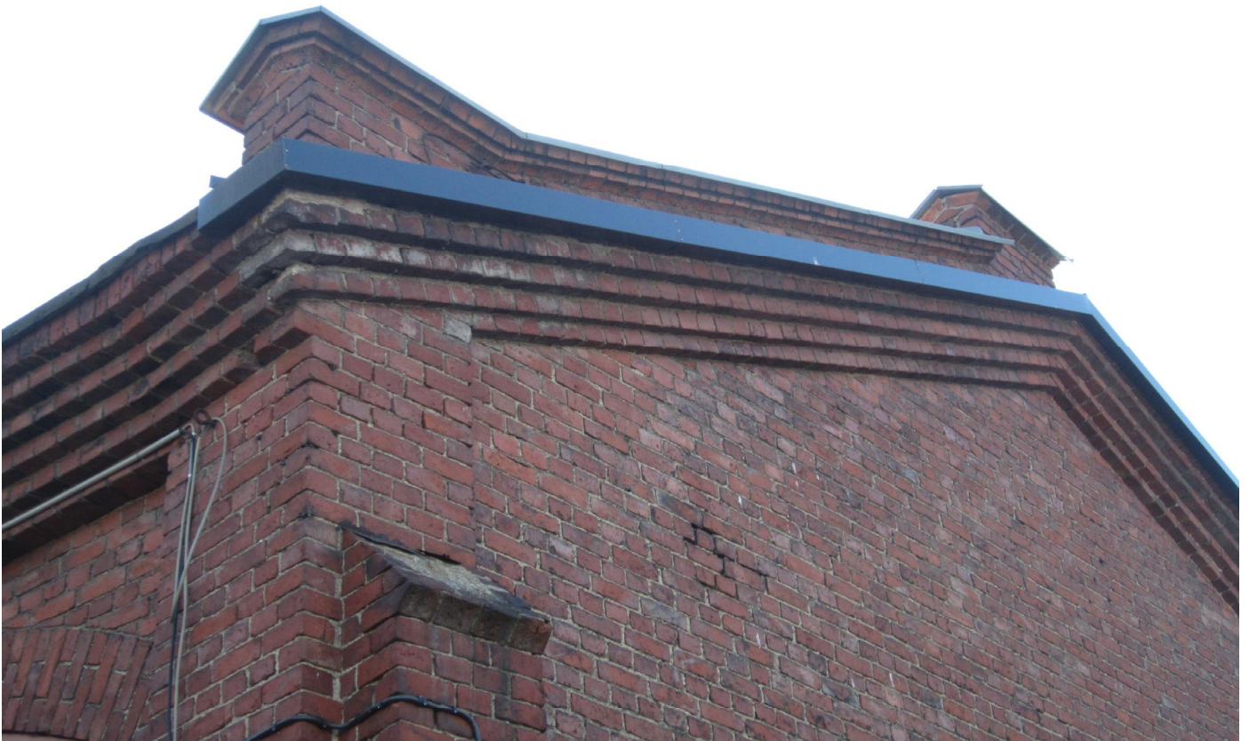
Länsijulkisivussa räystäiden ja muurinharjojen viehättävä ja rakennukselle omaleimainen detajjiikka on näkyvissä parhaiten, ja se on säilynyt suhteellisen hyvässä kunnossa. Kontreforin harjaa suojannut pellitys on ruostunut pois ja tilanne edellyttää nopeaa uudelleensuojaamista. Valokuva: Panu Savolainen.
