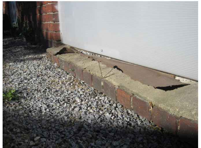
Eteläisen julkisivun ikkunapellitykset ovat lähes hävinneet korroosion myötä. Valokuva: Panu Savolainen.
