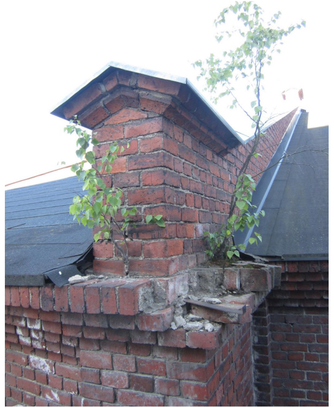
Länsipuolen täystäässä kattorakenteisiin on päässyt juuriutumaan useita koivuja, joiden juurastot tuhoavat räystäiden ja muurinharjojen rakenteita nopeasti. Valokuva: Panu Savolainen.
