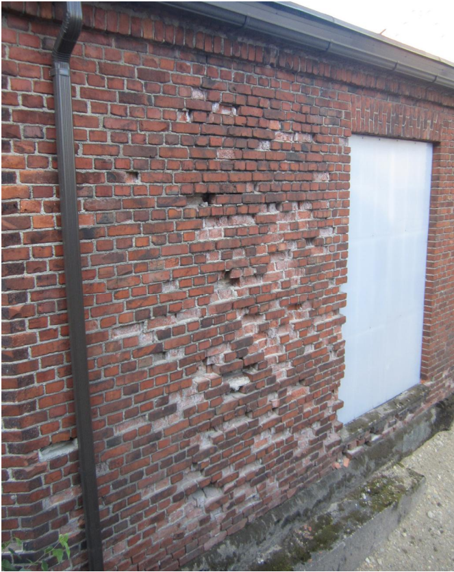
Veturitallin tiilijulkisivut ovat pääosin hyvässä kunnossa, mutta auringonvalolta peittyvässä koillisessa julkisivussa on nähtävissä vakavaa pakkasrapautumista. Valokuva: Panu Savolainen.
