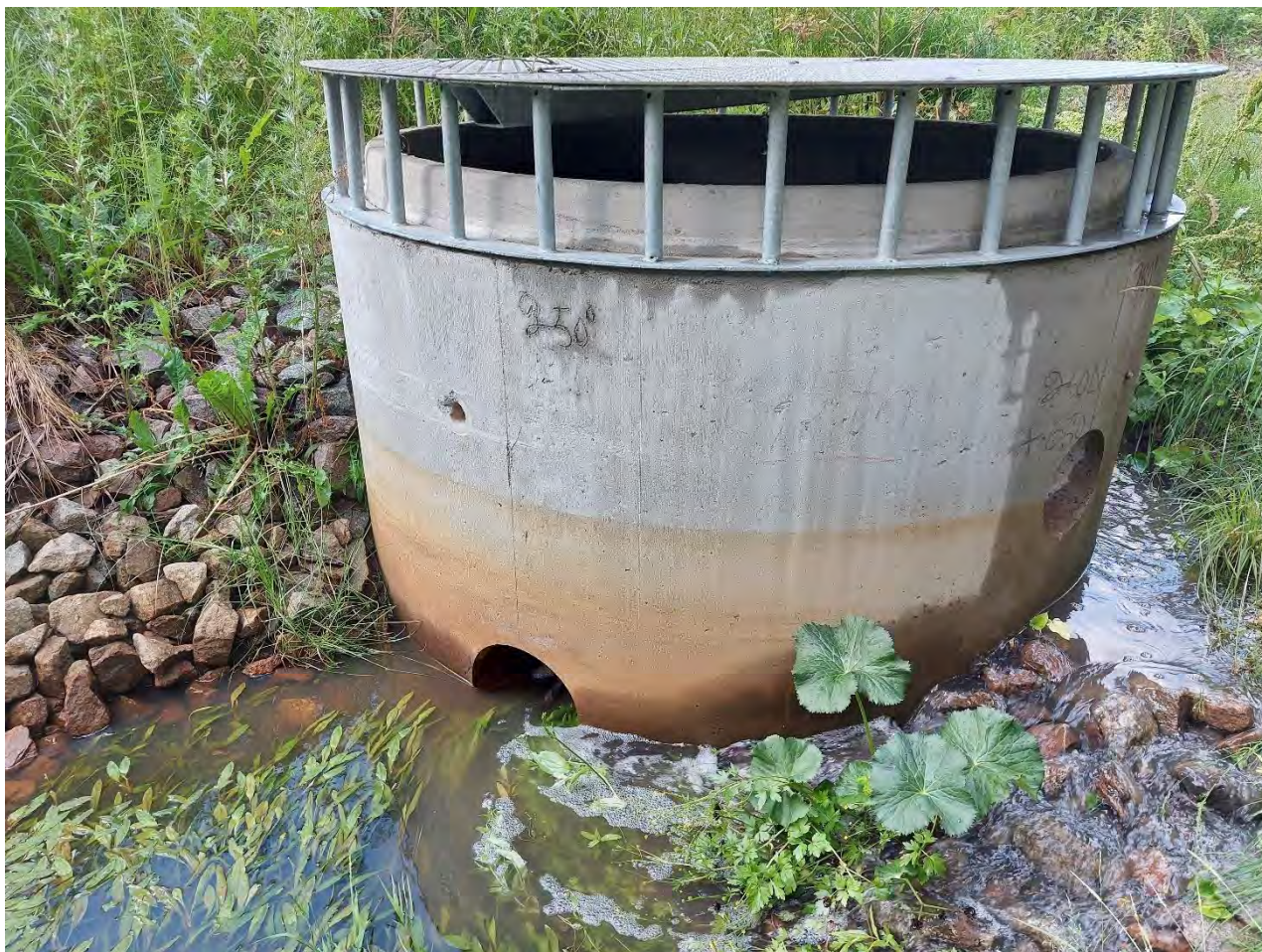
Kuva 1. Mediparkin kaava-alueella Teiskontien varressa nykyisellä kosteikkomaisella hulevesien hallinta-alueella sijaitseva virtauksensäätökaivo.
