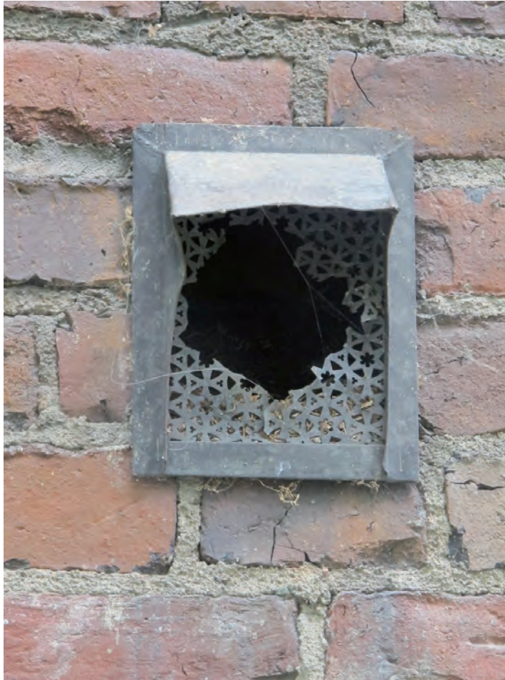
Vanha painovoimaisen ilmanvaihdon koristeellinen säleikkö on rikki ja sen takana on todennäköisesti linnunpesä.
