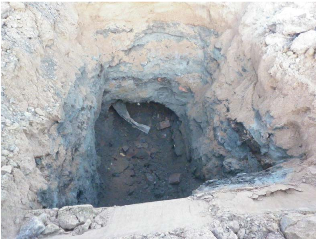
Kuva 8. Koekuoppa KK4. Rikkoutunut salaojaputki kuvassa. Tiilenpalaset nähtävissä koekuopan seinämissä.
