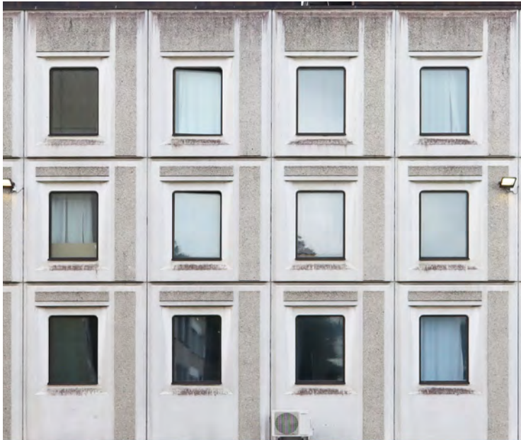
Julkisivut ovat edelleen silmämääräisesti hyväkuntoiset, mutta karheisiin ja viistettyihin pintoihin on tarttunut vuosien saatossa likaa.
