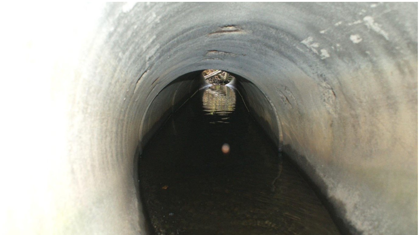
Kuva 8. Notkahtanut kevyen liikenteen väylän rumpu (800 B)
