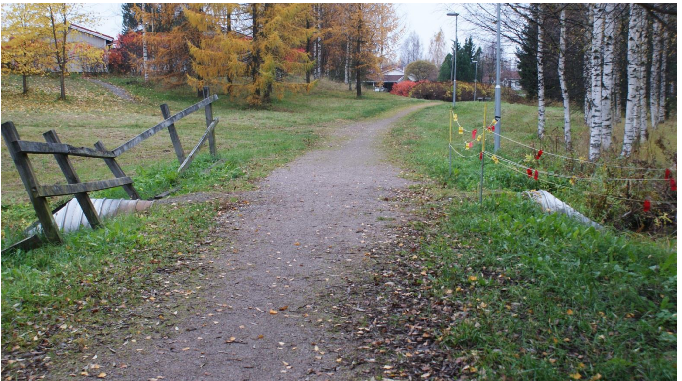
Kuva 10. Painunut teräsrumpu. Molemmat päät ylhäällä.
