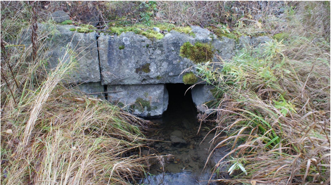
Kuva 6. Ratarummun yläpää (n. 0,4*0,8 m).
