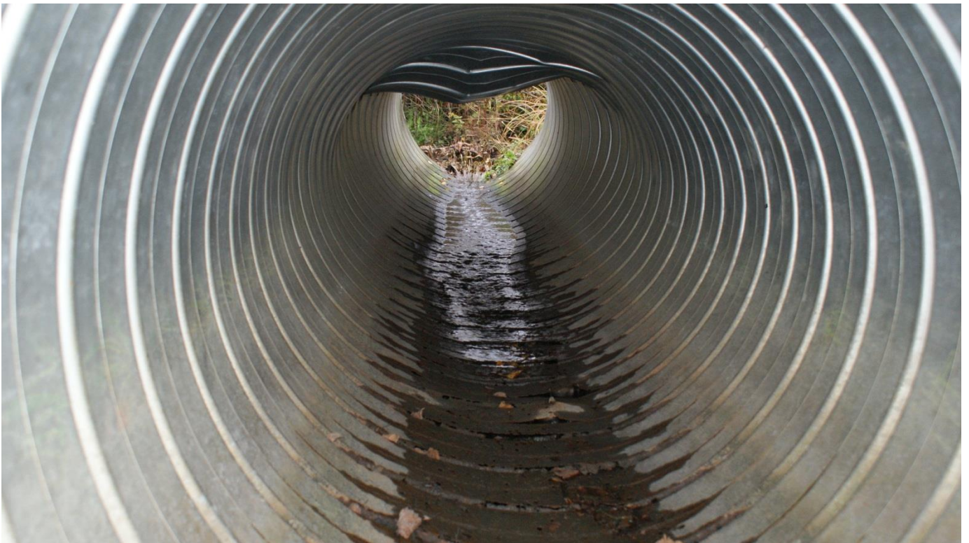
Kuva 9. Painunut ja ruostunut teräsrumpu (1000 T). Kuvassa virtaava vesi läpäisee rummun ruostuneista rei'istä.
