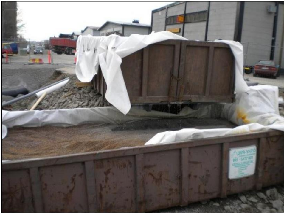
Kuva 14 Hulevesien suodatus vaihtolavoissa (Riipinen, M. 2013. Vesien käsittely työmailla – valvontaa ja ohjeistusta Helsingissä.)
