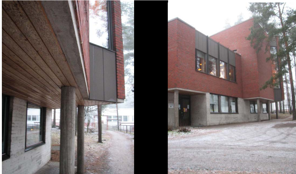
Kuva: Kirkon materiaaleja rinteen alapuolelta, punatiiltä, julkisivulevyjä, lakattua puuta ja betonia, jossa näkyvät muottilaudoituksen jäljet.
