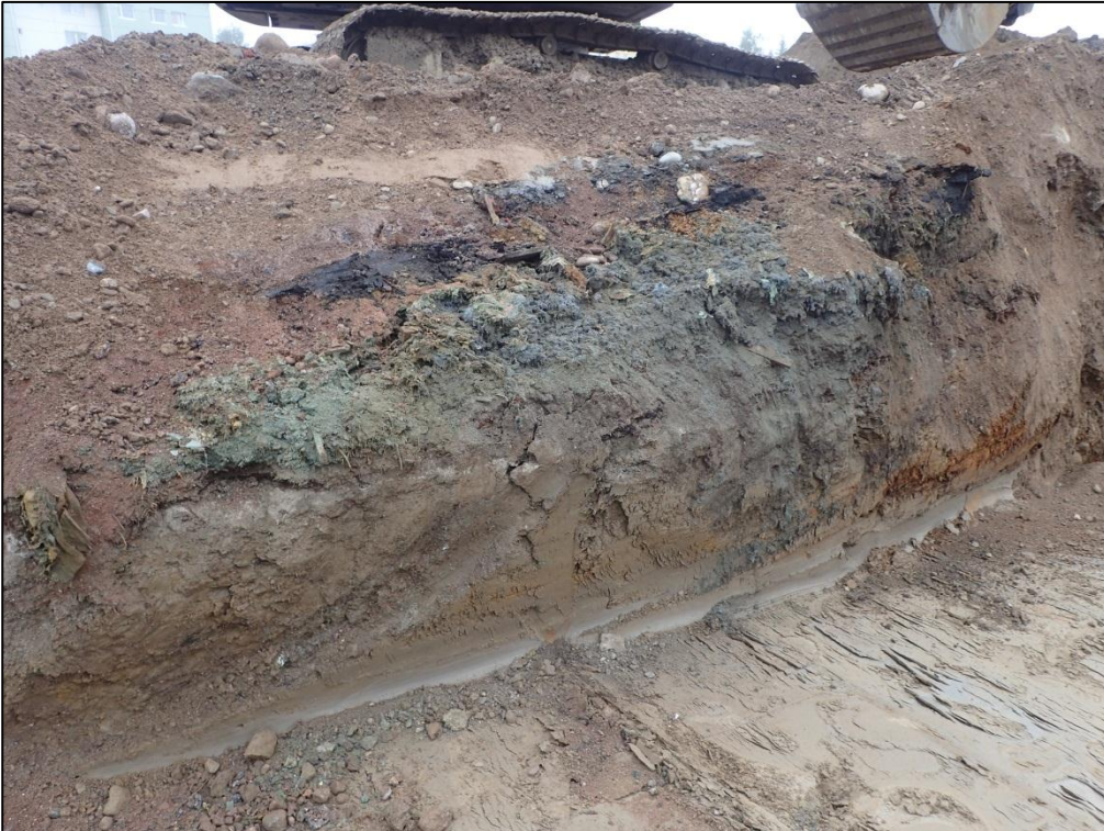
Kuva 15. 31.7.2015. Kaivua ruudusta B11. Kuvassa näkyvissä vaarallisen jätteen tasoisesti pilaantunutta maata.
