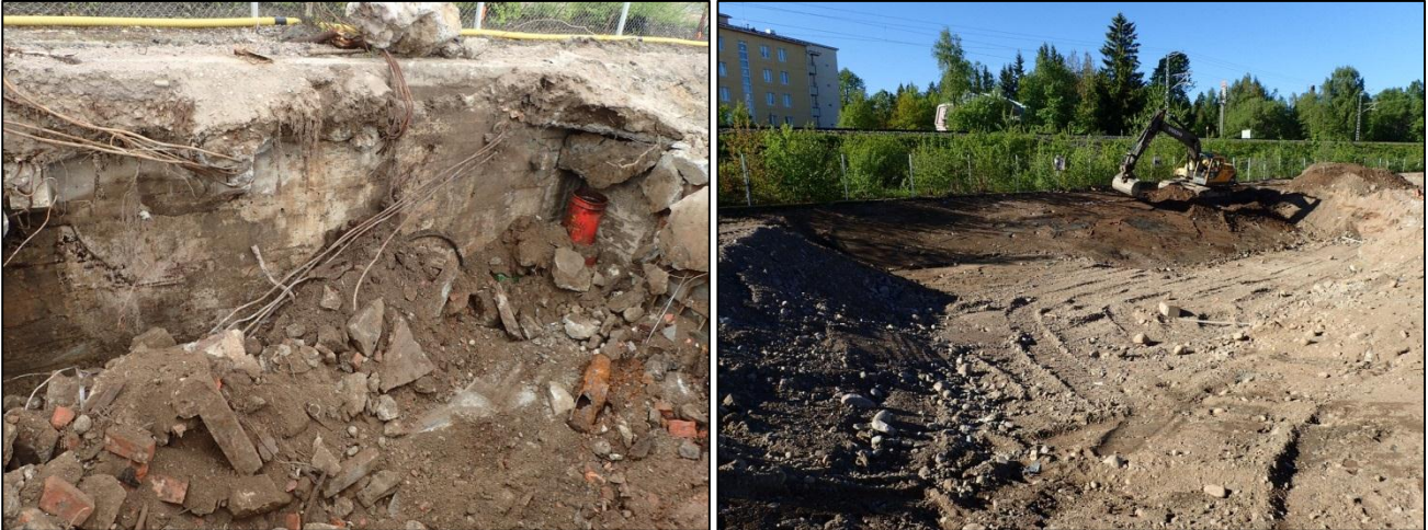
Kuvat 4 ja 5. 26.5.2015 ja 2.6.2015. D14 ruudusta löytyi kellari, joka oli täytetty metalliromulla ja tiilillä. Liuotinaltaan eteläpuolella olleisiin ruutuihin E7 ja E8 ei tehty koekuoppia luiskauksen vuoksi. Hajun vuoksi osa luiskan massoista kaivettiin erilleen ja näyte tutkittiin laboratoriossa.
