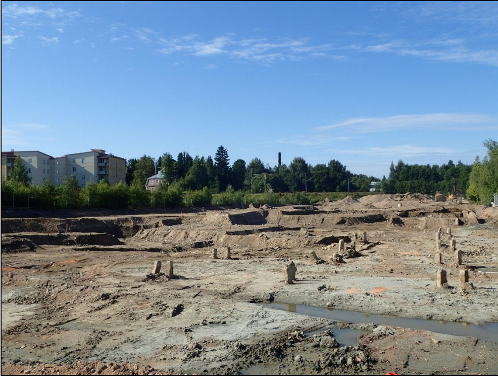
Kuva 16. 11.8.2015. Maaperästä löytyi vanhoja pilareita ja anturoita. Anturat kaivettiin pääosin pois, mutta isoimmat jäivät maaperään toistaiseksi ja pilarit on tarkoitus katkaista maanpinnan kohdalta.
