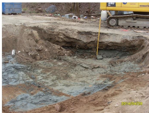
Kuva 4. Kuvassa jäännöspitoisuusalue JP3, pohjamaa, länsiseinä JP5 ja eteläseinämä JP7. Kaivannon syvyys n. 1-1,5 m.
