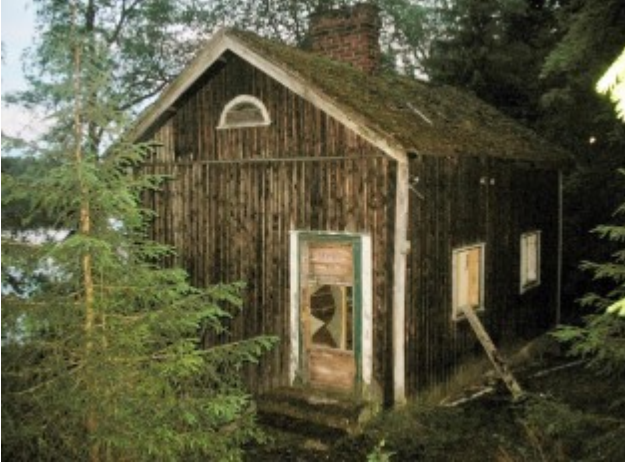
Kuva 7. Backmaninpuiston ränsistynyt ranatarakennus.
