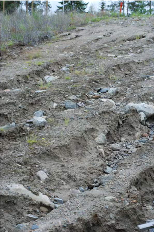
Kuva 2. Hulevesien aiheuttamaa rakennusaikaista eroosiota tietyömaalla (kuva Elisa Lähde)
