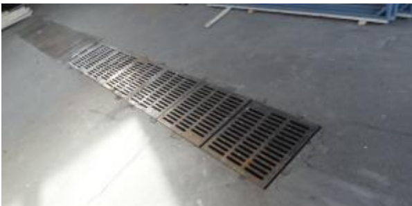
Kuva 12 Hallirakennuksen toinen öljynerotuskaivo
