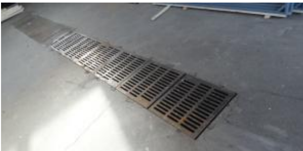
Kuva 12 Hallirakennuksen toinen öljynerotuskaivo
