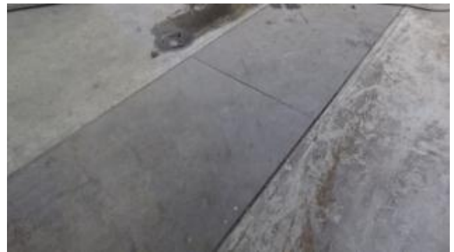
Kuva 16 Kellarikerroksen automaalaamon öljymonttu
