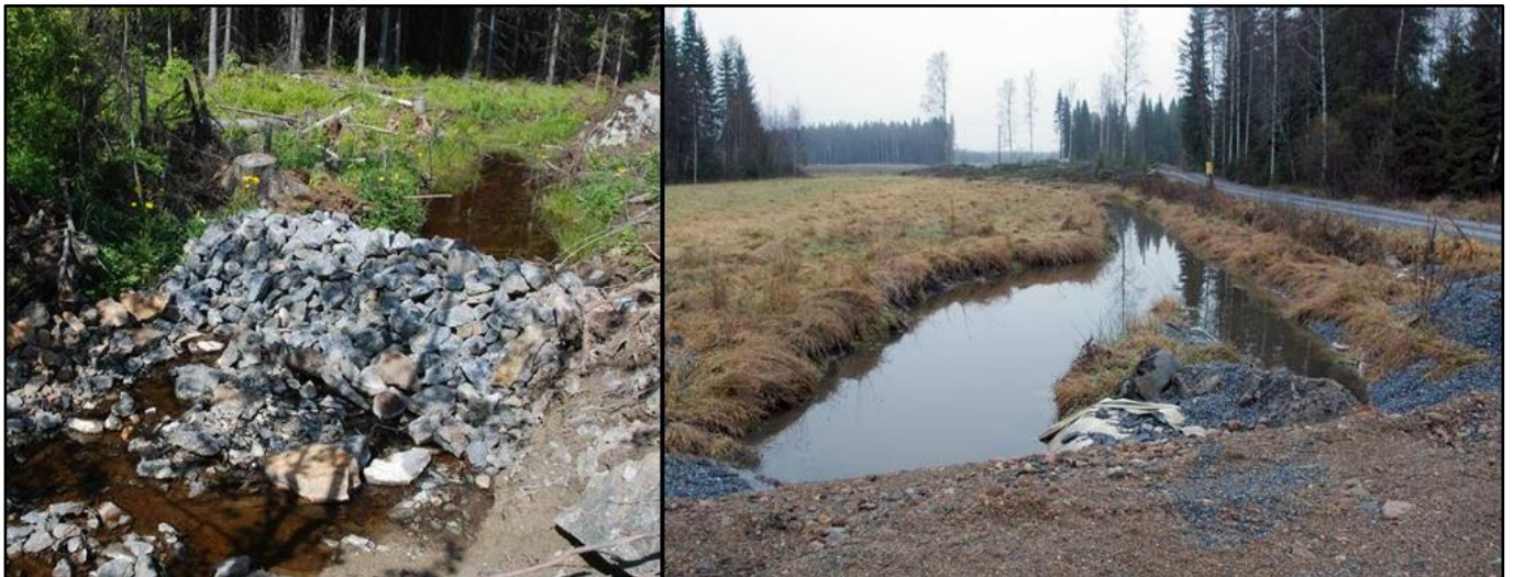
Kuva 14. Esimerkkejä Vuoreksessa tehdyistä, rakentamisen aikaisista suotopadoista ja laskeutusaltaista. Vasemmalla Koukkujärven laskuoja ja oikealla valtaoja Virolaisen alueella. 7
