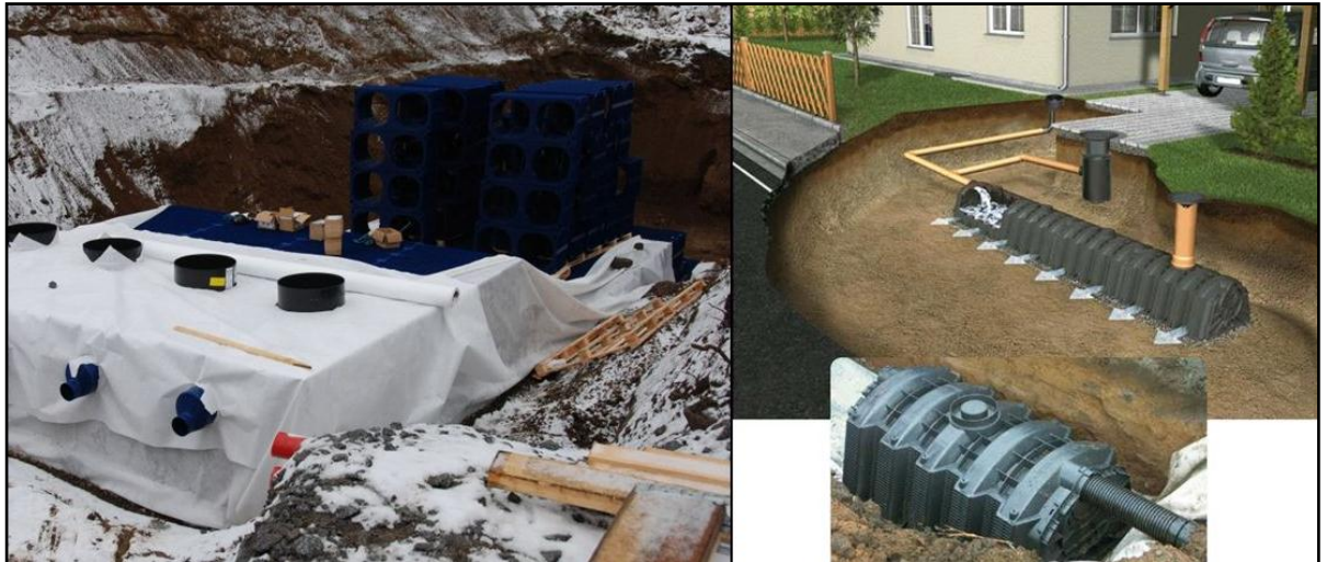
Kuva 5. Maanalaisia viivytyjärjestelmiä. Vasemmalla suurempi, noin 300 m 3 Wavin Labkon viivytyksen rakenteilla kerrostaloalueelle 7 ja oikealla Uponorin mm. pientaloon soveltuva hulevesitunneli 6 .
