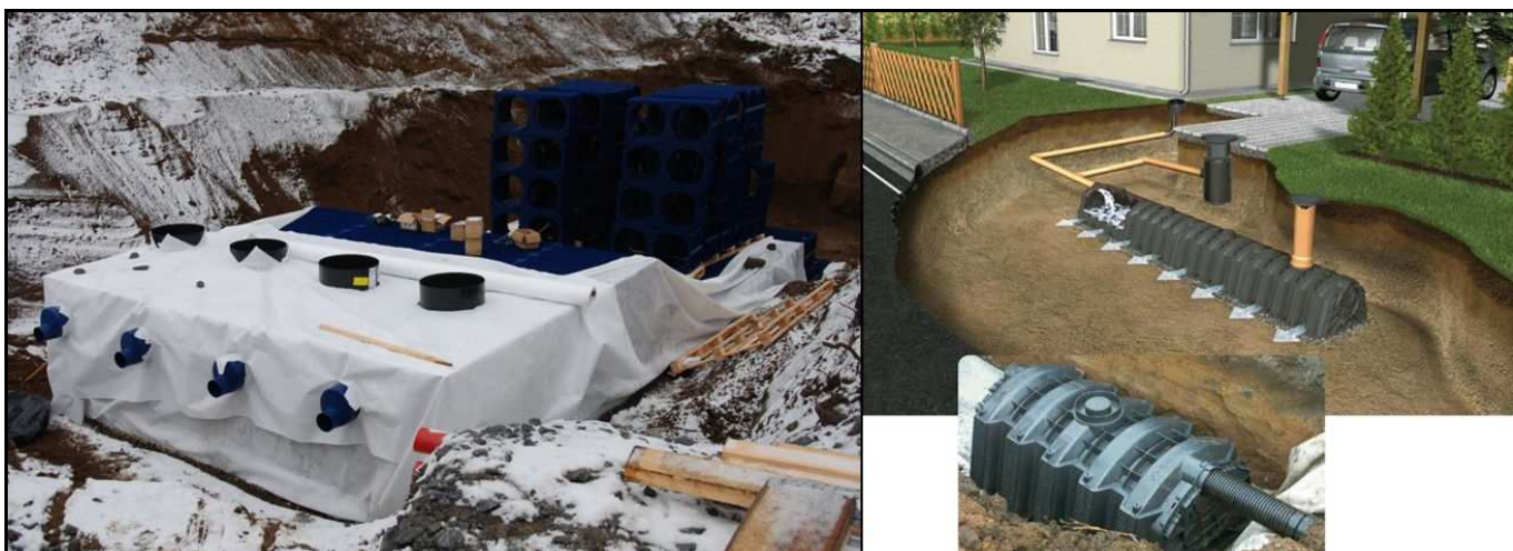
Kuva 14. Maanalaisia viivytysjärjestelmiä. Vasemmalla suurempi, noin 300 m 3 Wavin Labkon säiliö rakenteilla 5 ja oikealla Uponorin mm. pientaloon soveltuva hulevesitunneli 13 .
