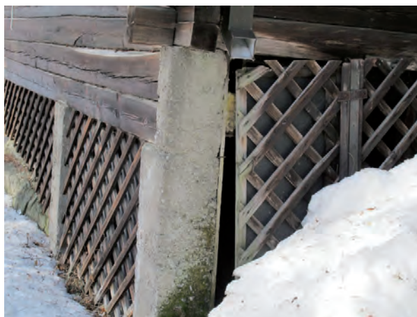
Kallistunut sokkelitolppa, jonka takaa pilkistävät pudonneet mineraalivillalevyt. Syöksytorven pää on liian korkealla.
