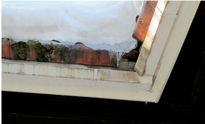
Vesikaton mineriittilevyräystäään sadevedet ohjautuvat ohi rännin. Rännit on asennettu vain sisääntulopihan räystäälle.
