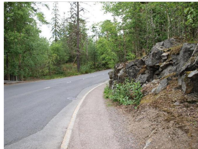
Kuva18. Kalliosta johtuva huono näkemä Pyynikintiellä
