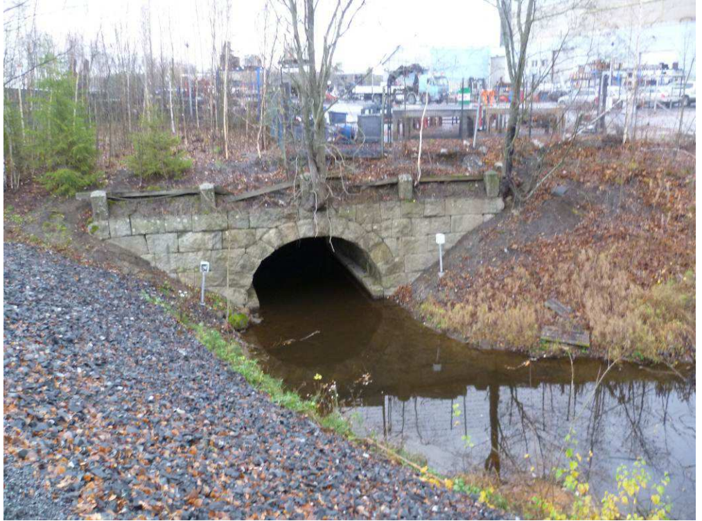
Kuva 9. Vanhan kivisillan eteläinen osa, joka on alkuperäisellä 1700-luvulta peräisin olevalla paikalla. Kivisillan pohjoisosa on siirretty Härmälänojan suuhun. Uoman rannat ovat jyrkkiä. Kuva: Laura Soosalu.
