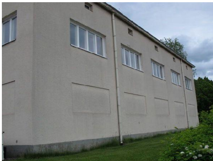
Julkisivu. Ensimmäisen kerroksen ikkunat on muurattu umpeen 1980-luvulla. Anna Lyyra-Seppänen
