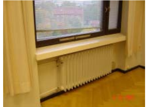
Kuva 38 Toimistohuoneiden ikkunasyvennyksessä on säilynyt monta alkuperäistä detaljia: ikkuna ja sen metallinen ilmanvaihtventtiili, vesikiertoinen riparadiaattori, ikkunalaista ilmankiortorakoineen ja kalanruotokuvioon ladottu parkettilattia.
