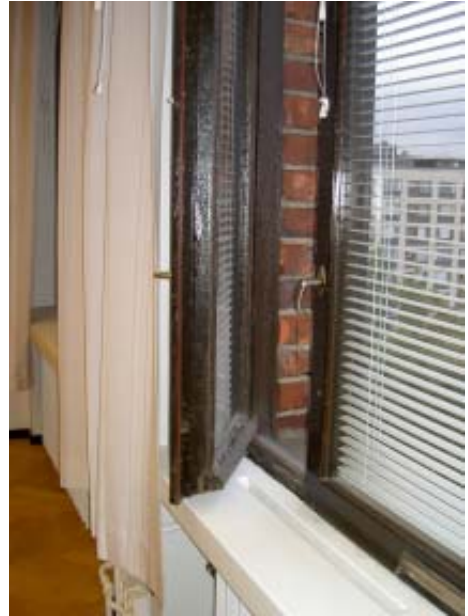
Kuva 37 Toimistohuoneen ikkuna eteläpäädyssä. Tuuletusosan sisä- ja ulkopuite on ruuvattu kiinteästi yhteen.
