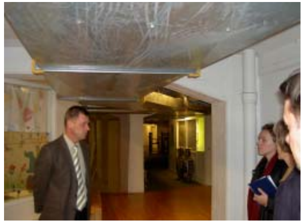
Kuva 46 Neljännen kerroksen kuntosalitilojen käytävää. Alakaton alapintaan tuodut ilmanvaihtokanavat madaltavat huonekorkeuden paikoitellen hyvin matalaksi.
