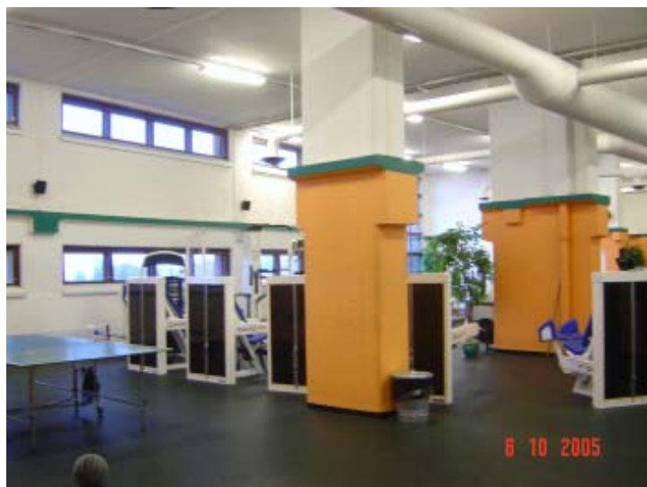
Kuva 32 Kuntosalituloja seitsemännessä kerroksessa. Vuonna 1979 puretun välipohjan jäljet näkyvät selvänä pilareissa ja seinillä. Välipohjan leikkauspinta on maalattu tummemmalla värillä.
