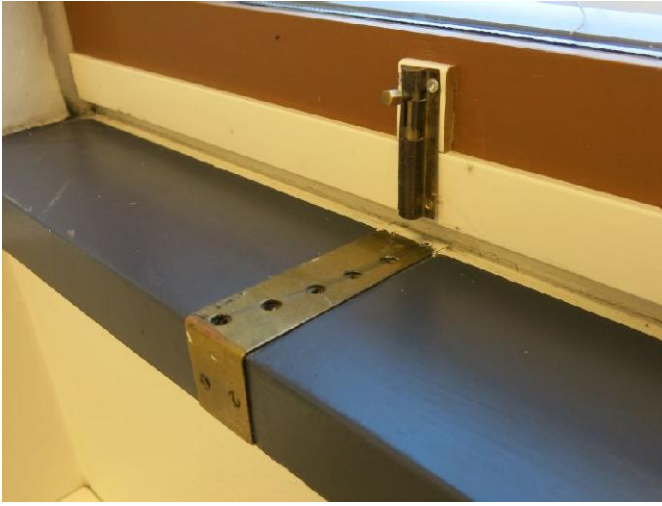
Kyy 166 : 119 Tredu Sammonkatu, päärakennuksen luokkatilan ikkunan aukipitosalpa. Mirkku Haapasaari 24.11.2015
