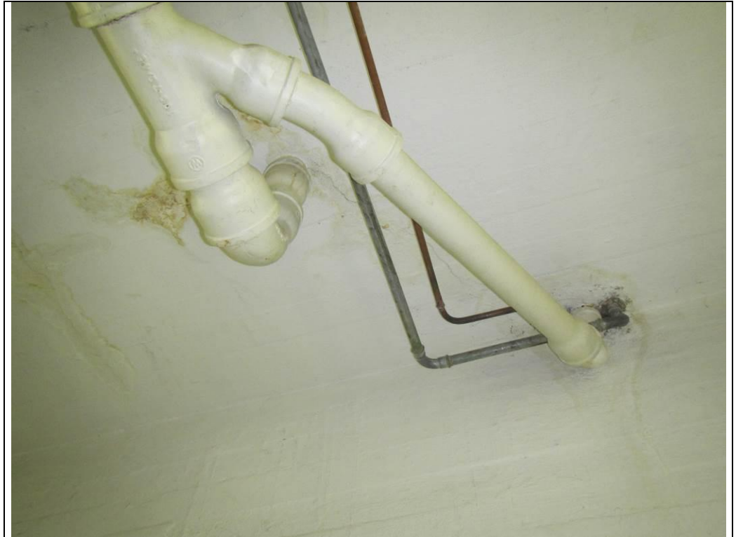
Kuva 26. Käyttövesi- ja viemäriverkostoa.
