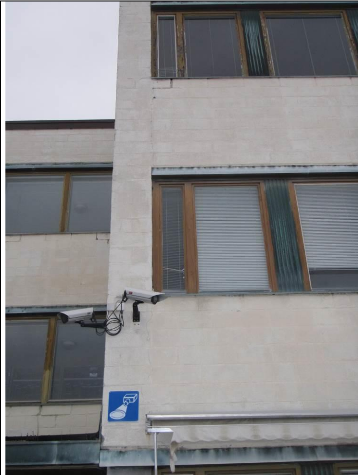
Kuva 9. Julkisivussa esiintyy halkeamia.
