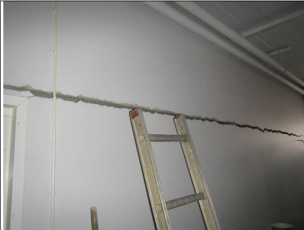
Kuva 3. Kellarikerroksen suuret halkeamat.
