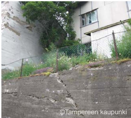
Kuva: Huonokuntoista betoni- muuria Provastinkadulla
