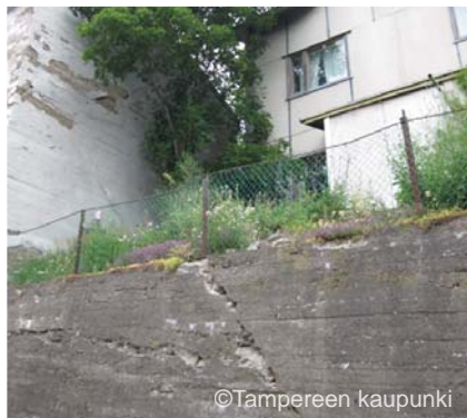
Kuva: Huonokuntoista betoni- muuria Provastinkadulla
