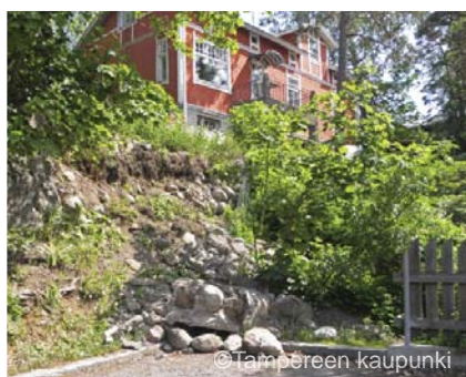
Kuva: Sortunut muuri Provastin- kadulla
