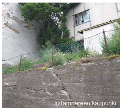
Kuva: Huonokuntoista betoni- muuria Provastinkadulla
